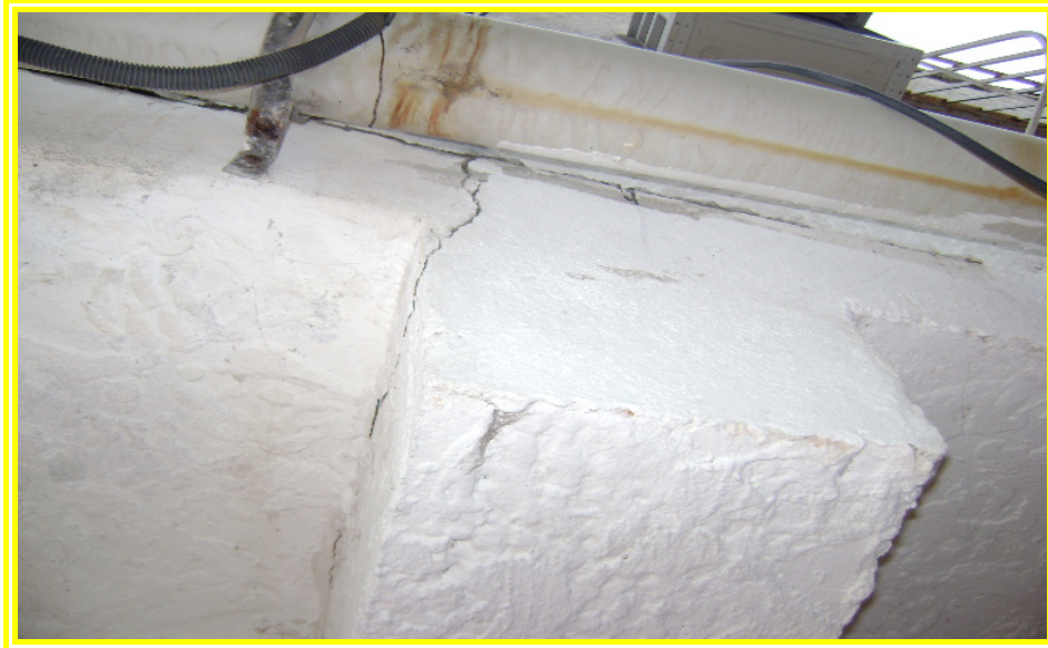
Fig. 4.28 Grietas en la viga que llegan hasta la losa.
