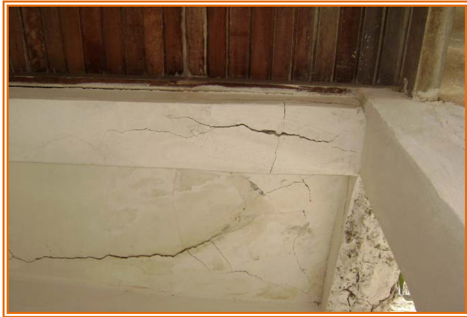
Fig. 4.5 Grietas horizontales y verticales en la viga.
