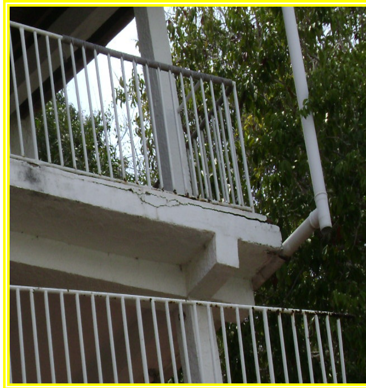
Fig. 4.29 Grietas en la losa de entrepiso.
