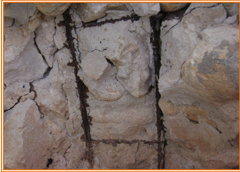
Fig. 5.5 Reacción de la fenolftaleína sobre la columna del muro y efectos de la corrosión del acero
