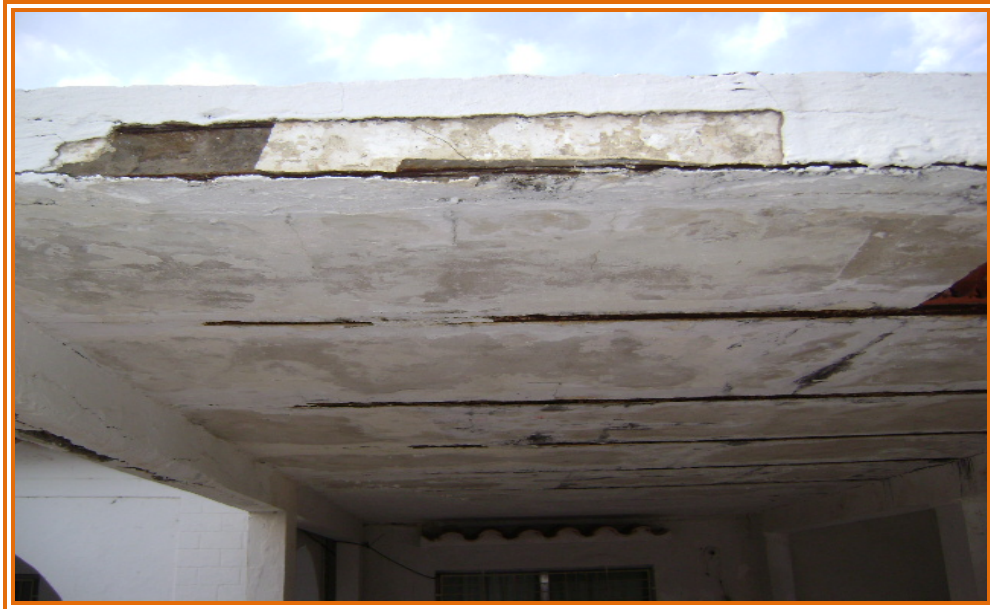
Fig. 4.11 Desprendimiento del recubrimiento en la losa tabelón, debido a la corrosión del acero de refuerzo.
