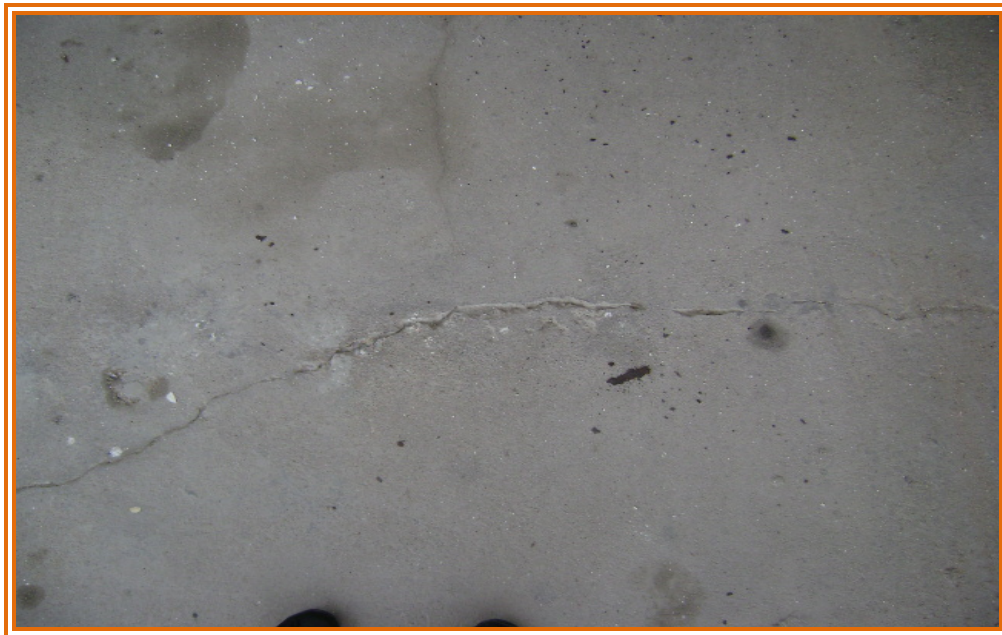
Fig. 4.9 Grietas en losa de piso.
