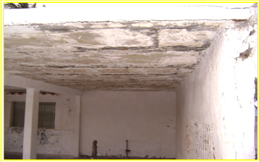
Fig. 4.12 Grandes filtraciones en la losa, producen corrosión del acero y desprendimiento del concreto.
