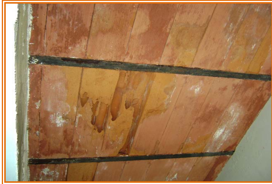
Fig. 4.21 Ruptura de los tabelones y corrosión del perfil metálico.
