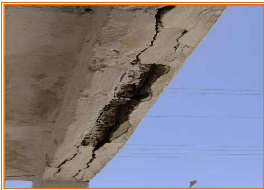
Fig. 4.6 Desprendimiento del concreto en la viga.
