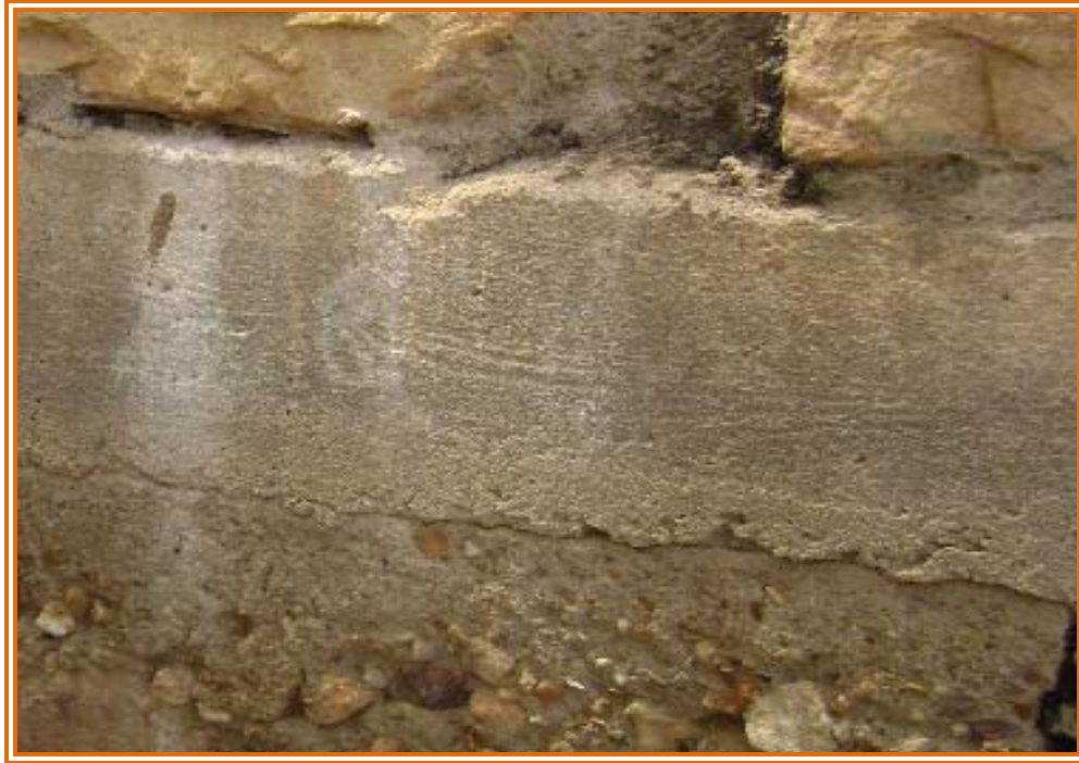
Fig. 5.6 Presencia de iones cloro en la viga del muro.
