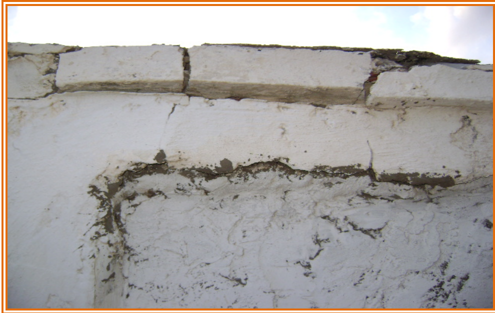
Fig. 4.10 Grietas verticales en la losa.
