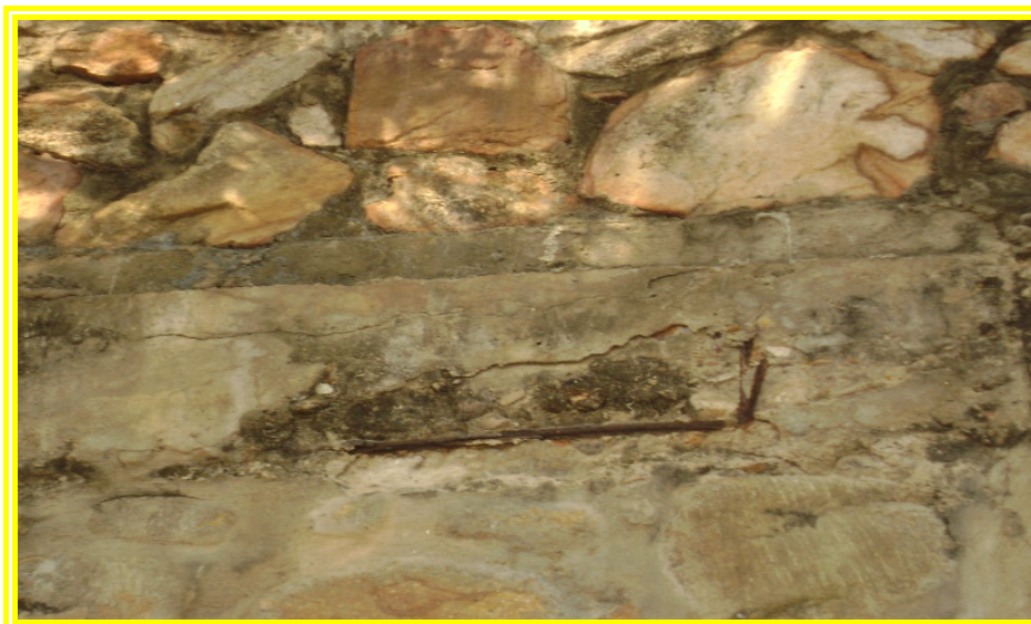
Fig. 4.27 Corrosión en las barras de refuerzo.
