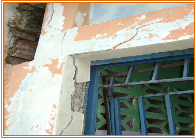
Fig. 4.19 Grietas inclinadas y verticales desde la columna a la viga.
