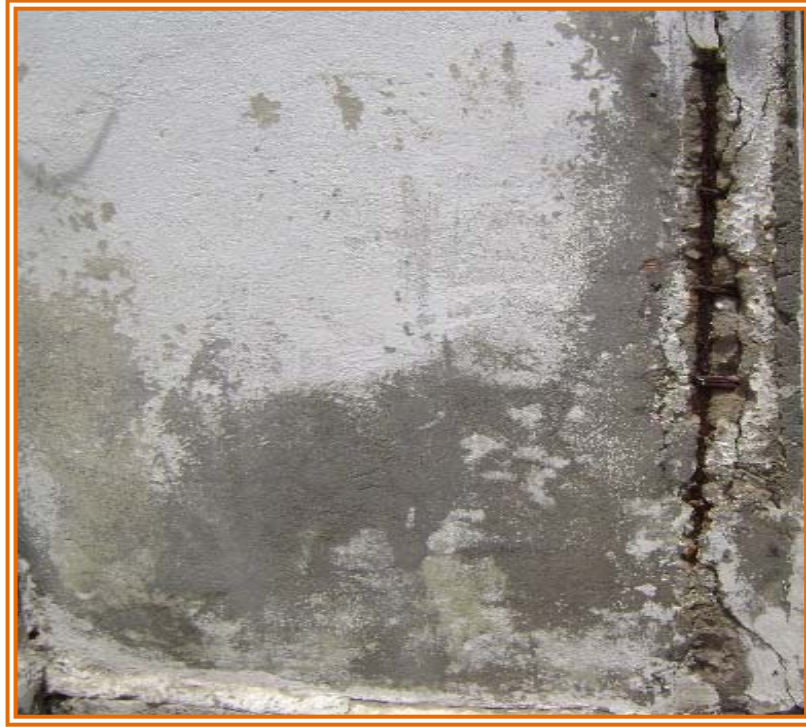
Fig. 4.18 Desprendimiento del material en las columnas.
