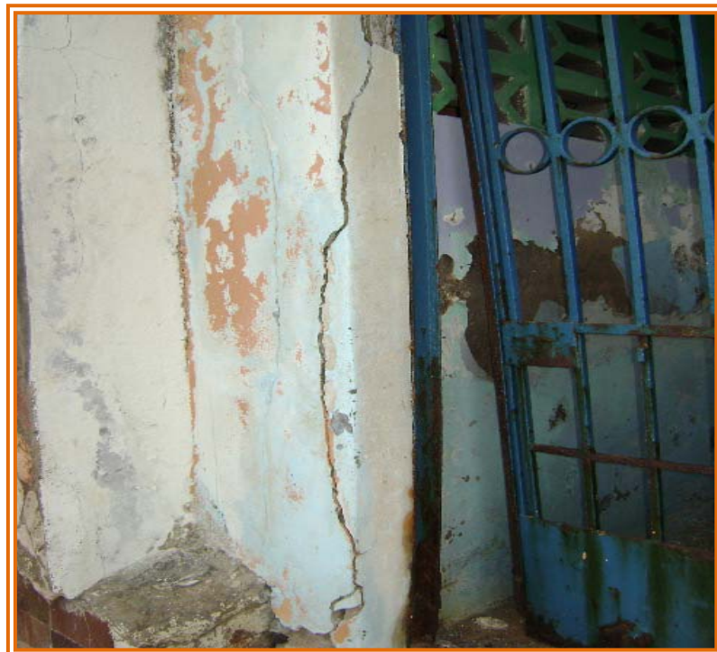
Fig. 4.17 Grietas longitudinales en columna.
