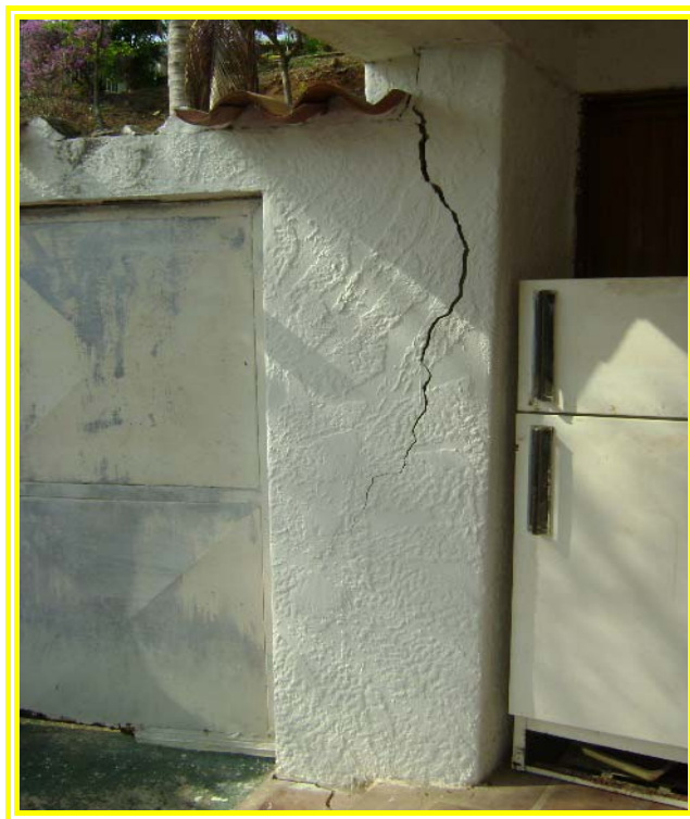
Fig. 4.23 Grietas de gran espesor en la columna.
