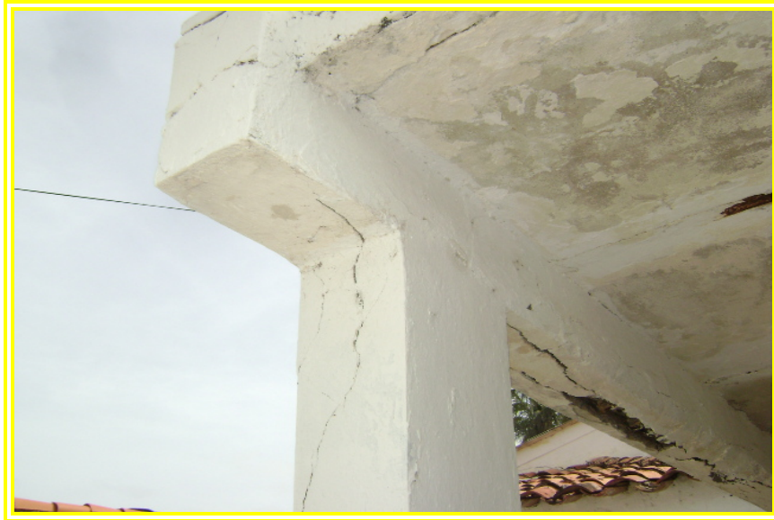
Fig. 4.7 Grietas en el nodo.
