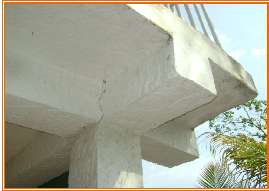
Fig. 4.24 Grietas en el nodo.
