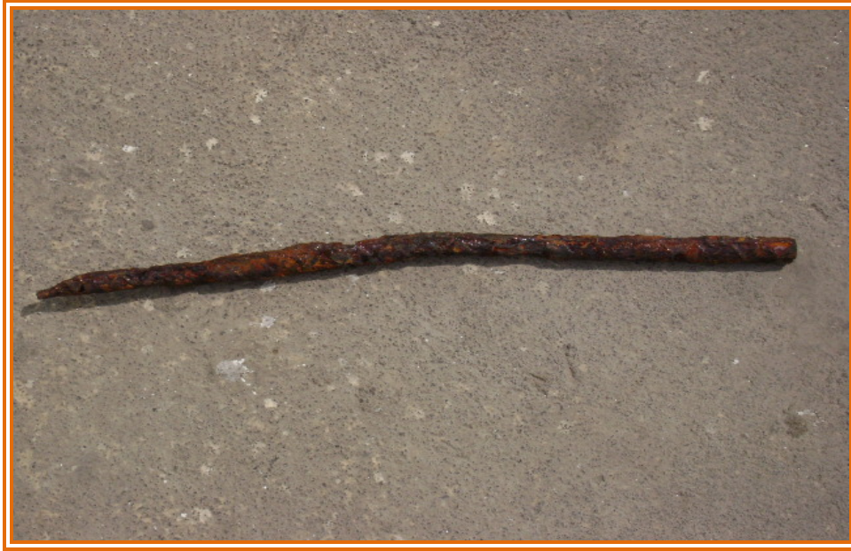
Fig. 5.8 Cabilla estriada con presencia de corrosión.
