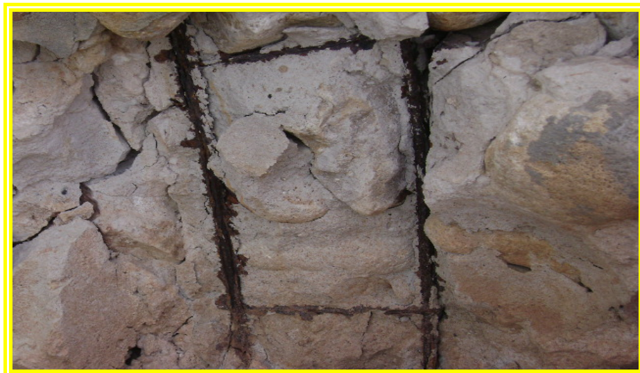
Fig. 4.25 Exposición de cabillas corroídas en la columna del muro.
