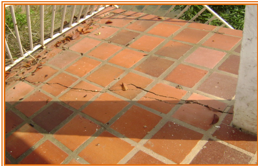
Fig. 4.30 Grietas en la losa de piso.
