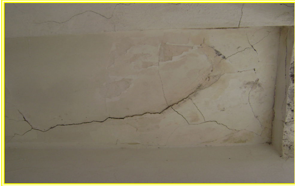
Fig. 4.14 Grandes grietas longitudinales en la losa de techo.
