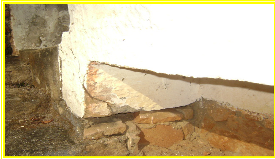
Fig. 4.26 Grietas en la viga
