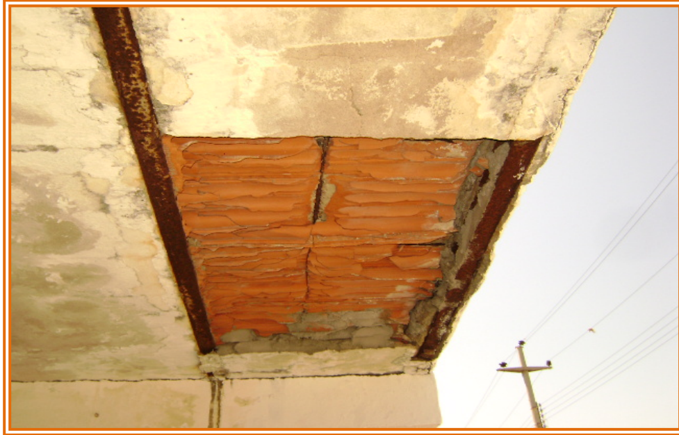
Fig. 4.15 Rotura de los tabelones y corrosión del perfil metálico.
