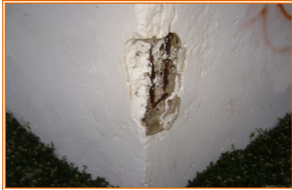
Fig. 4.4 Desprendimiento del concreto en las columnas, con exposición del acero de refuerzo.
