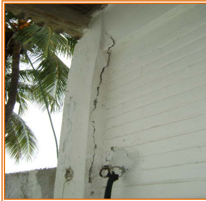
Fig. 4.2 Grietas verticales de gran tamaño en Columnas.
