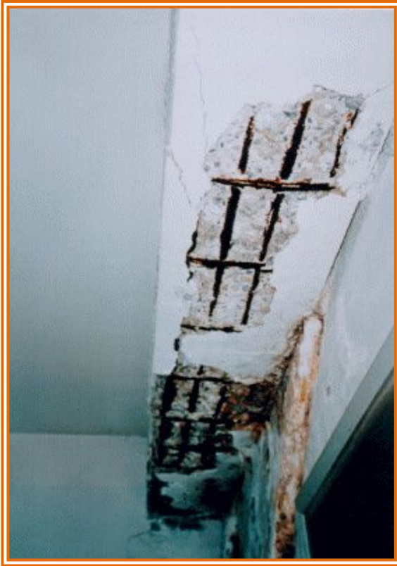
Fig. 2.5 La corrosión ha provocado el desprendimiento del recubrimiento de concreto causando la visibilidad y la vulnerabilidad de las armaduras de la viga.
