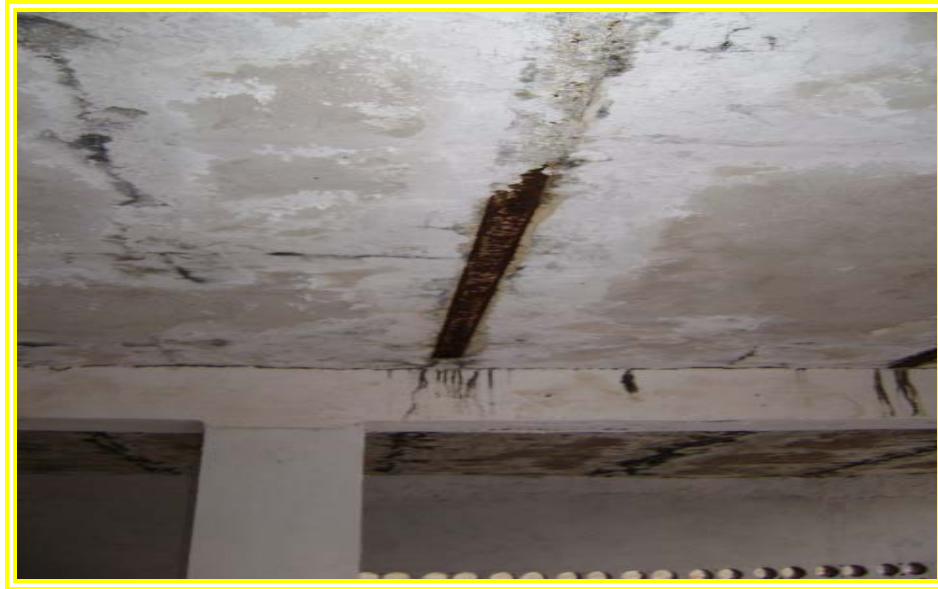
Fig. 4.13 Corrosión del perfil metálico
