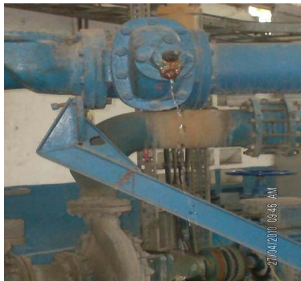
FUGA EN VÁLVULAS.
