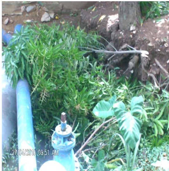
AUSENCIA DE VÁLVULA.
