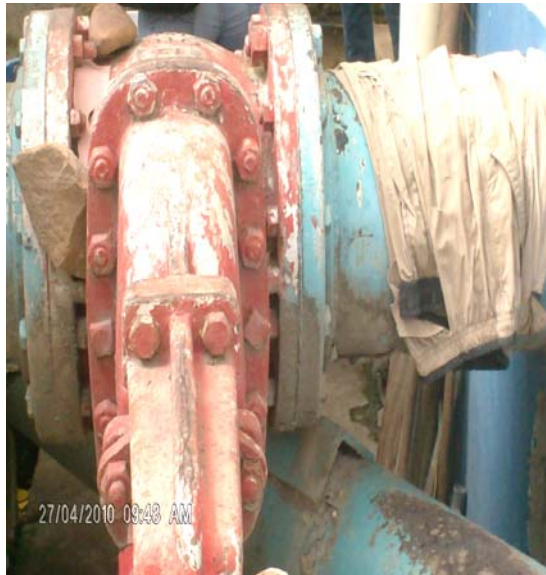
LOS ELEMENTOS DE LA ESTACIÓN ESTÁN DETERIORADOS POR LA CORROSIÓN
