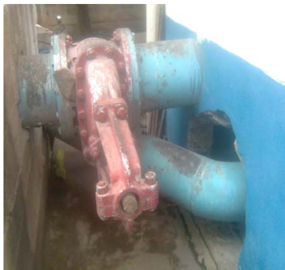
CONDICIONES ESTRUCTURALES NO APTAS
