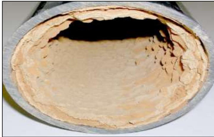
Figura 3.7 Asentamiento de arenas en las tuberías. Fuente: Wikipedia.
