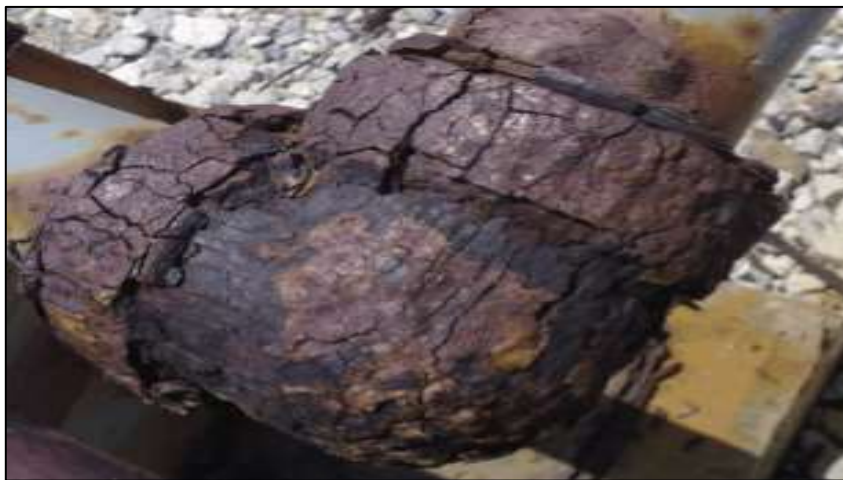
Figura 3.10 Tubería que presenta Corrosión por erosión Fuente: Delgado. (2016)
