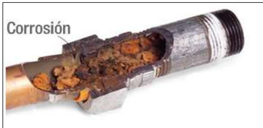
Figura 3.9 Ejemplo del problema corrosivo en las tuberías.
