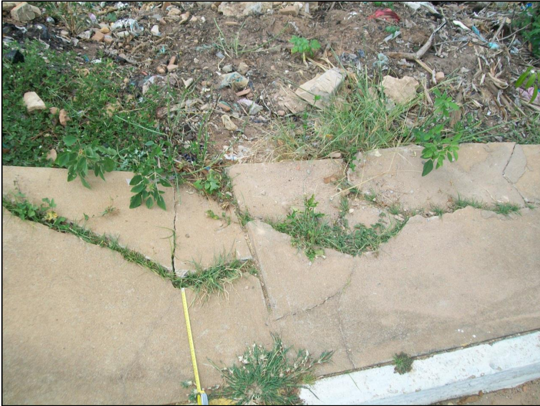
Figura 5.7 Destrucción de la acera del sector de estudio.
