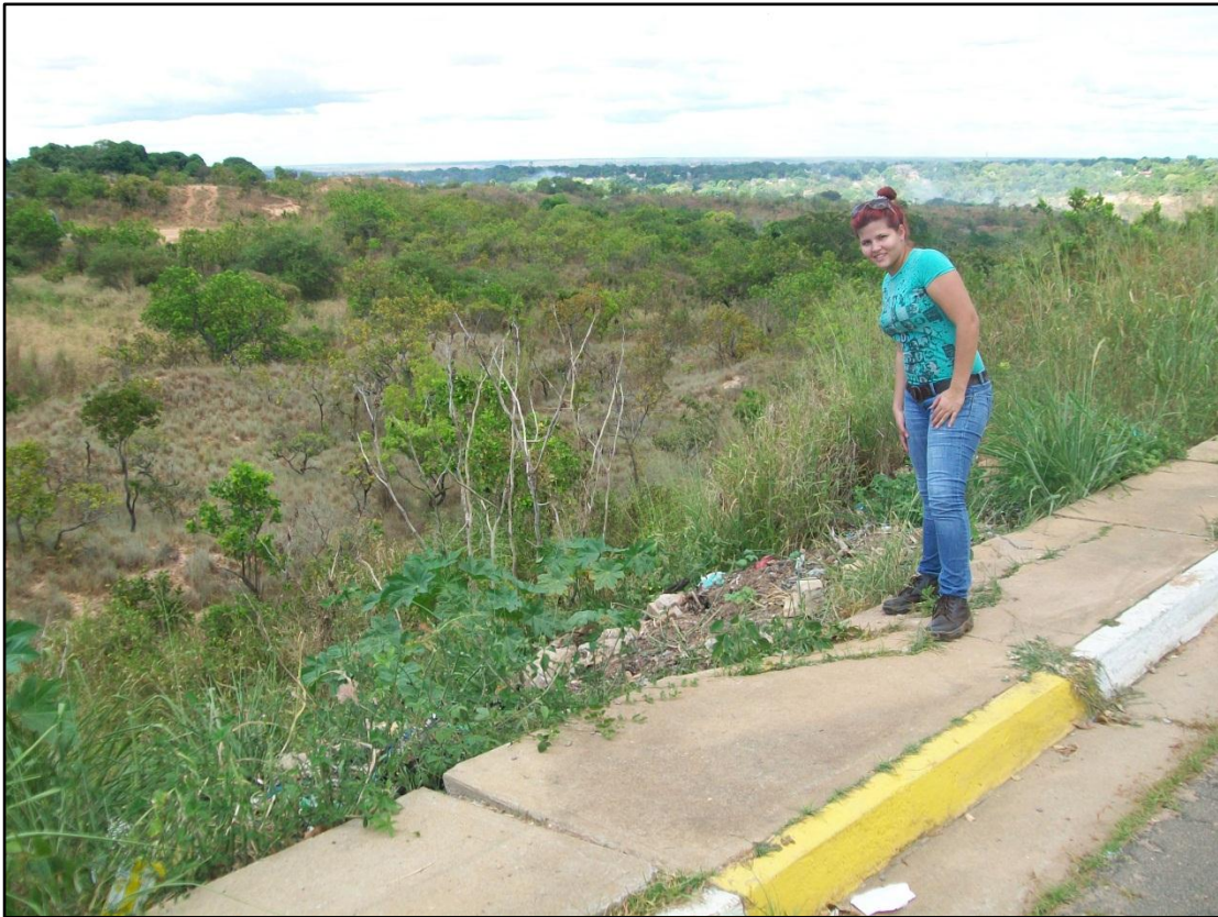
Figura 5.3 Acera afectada por la cárcava.
