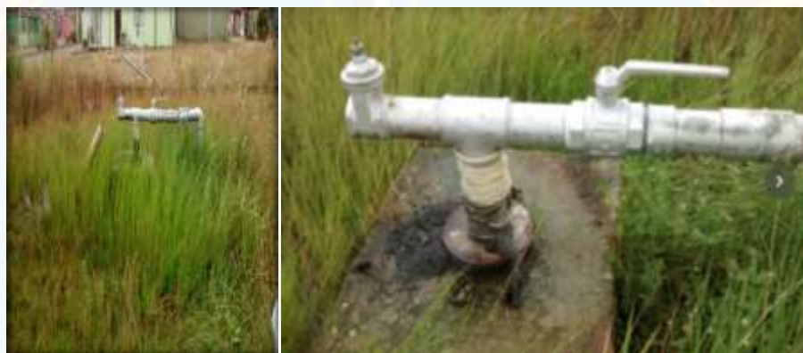
Figura 10. Condiciones actuales del Pozo 5 de la Zona Este Urbana (ZEU), urbanización Los Tapiales II parroquia Las Cacuizas
