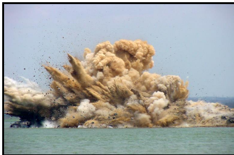
Figura 5.10 Voladura de los morros de Guarampo en el sector Matanzas – Palo Solo.
