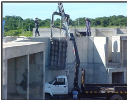
Planta de Tratamiento Maurica
