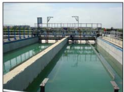
Lagunas de saneamiento.
