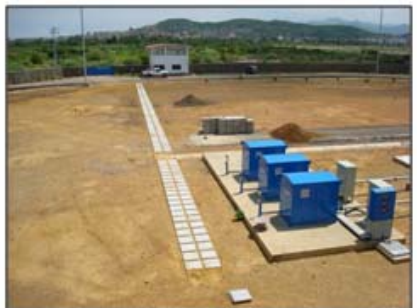
Planta de Tratamiento.
