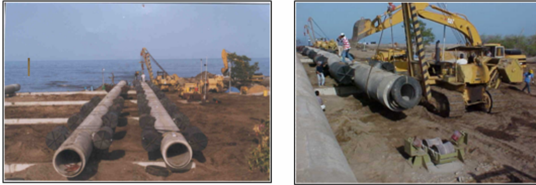
Figura N°67: Sistema de drenaje, tuberías de descarga al mar, Barcelona, estado Anzoátegui
