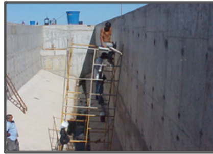
Planta de Tratamiento Maurica.
