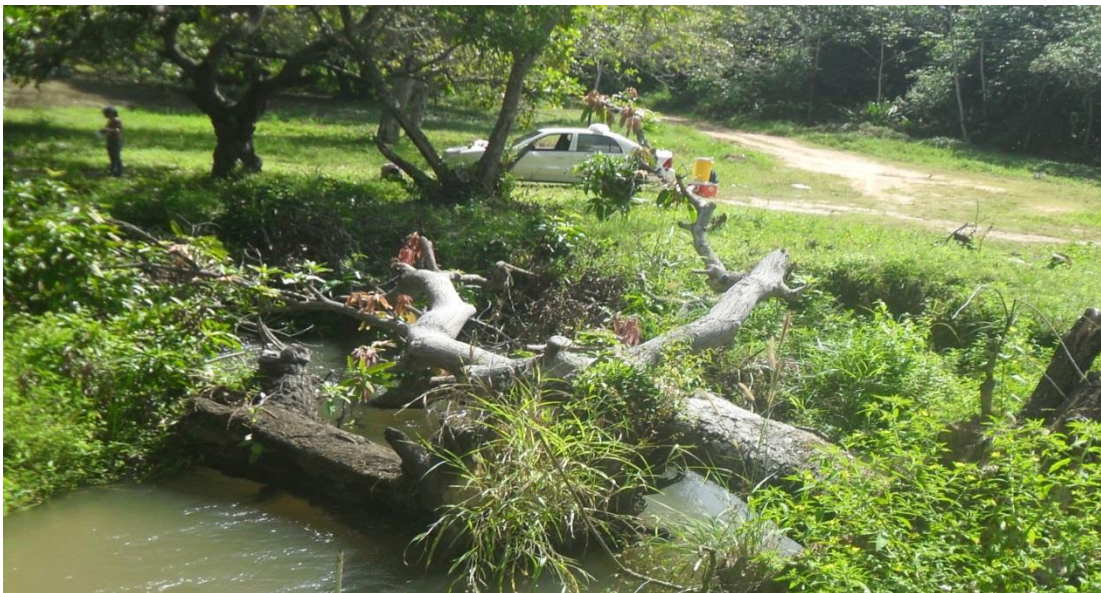
Figura 5.30 Socavación de ribera del río La Canoa (Brines y Sambrano, 2019).
