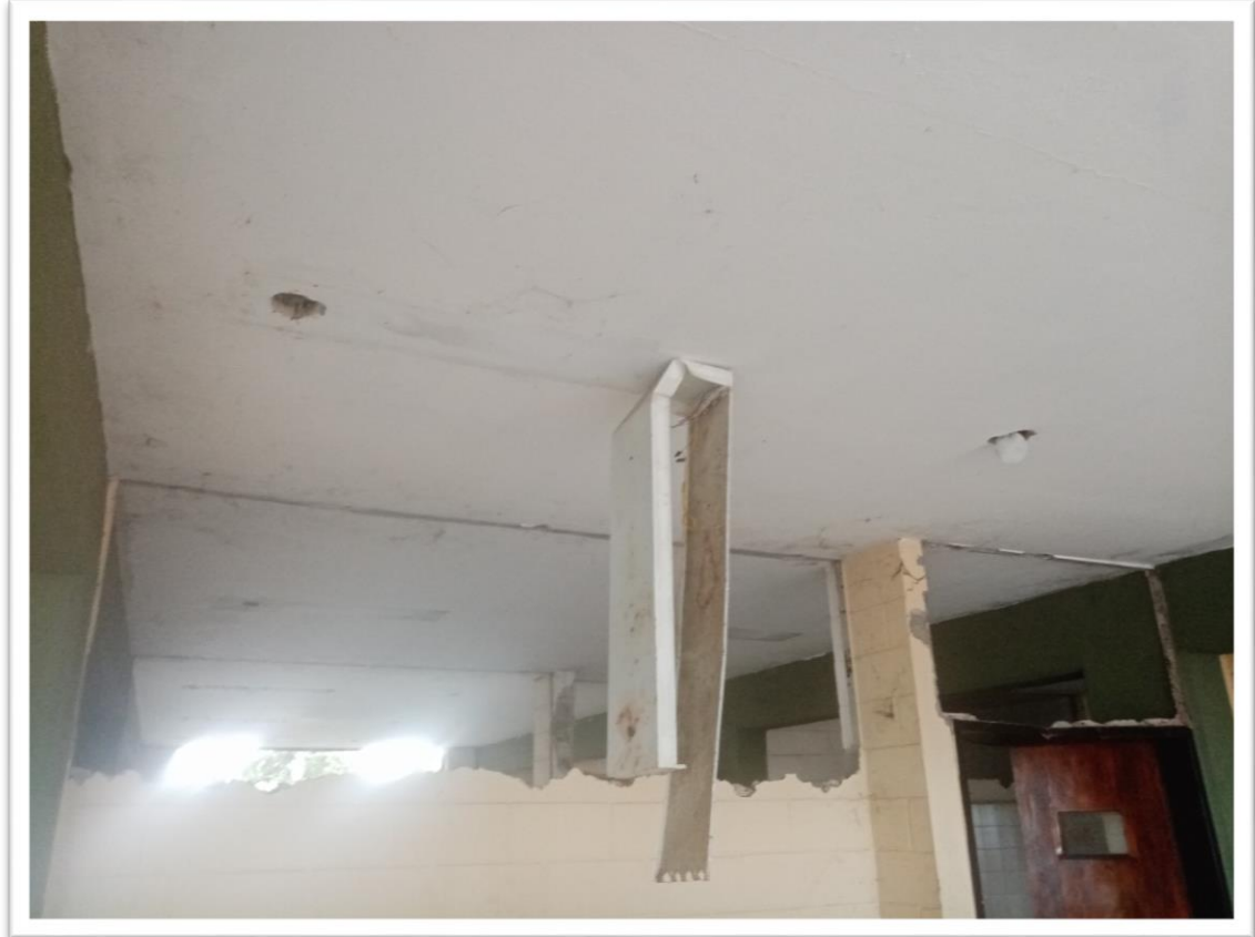
Fig 5.6 Condición de la mayoría de las lámparas y salidas de luces de la edificación de cursos básicos. Fuente: Tomada de Visita de campo, 2022.
