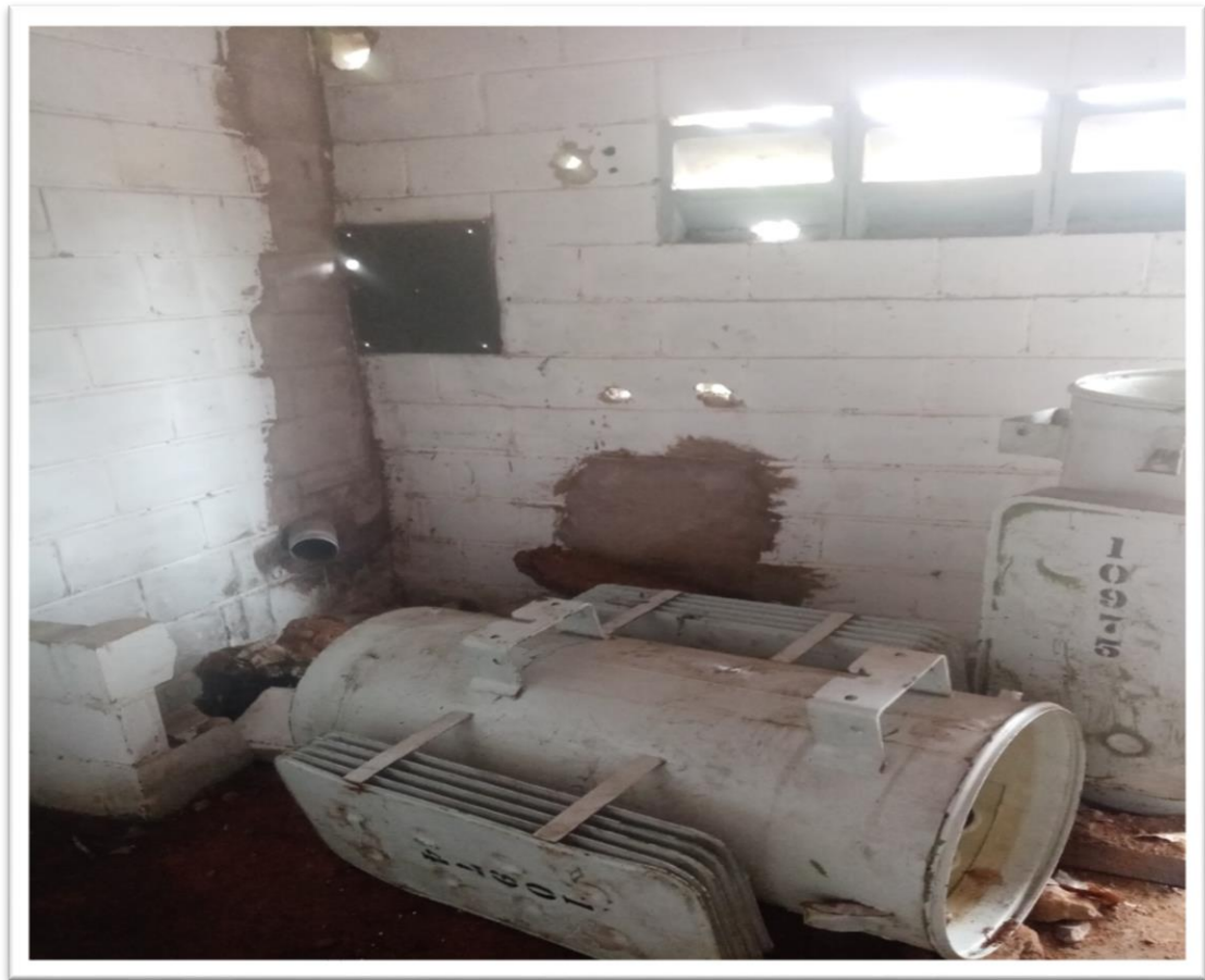
Fig 5.2 Condiciones del banco de transformadores que daban la tensión de energía a la edificación de cursos básicos. Fuente: Tomada de Visita de campo, 2022.
