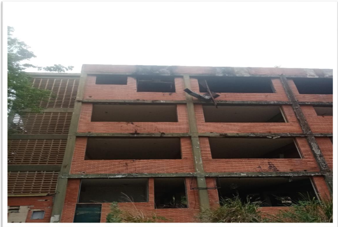
Fig 5.1 Columnas de concreto, sin tubería ni cableado de líneas repartidoras. Fuente: Tomada de Visita de campo, 2022.
