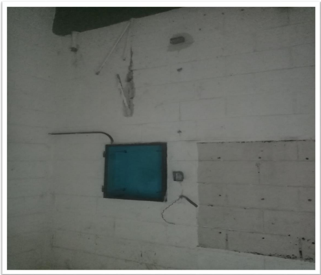
Fig 5.5 Condición del tablero eléctrico del primer nivel de la edificación, que dan circuito a los laboratorios. Fuente: Tomada de Visita de campo, 2022.
