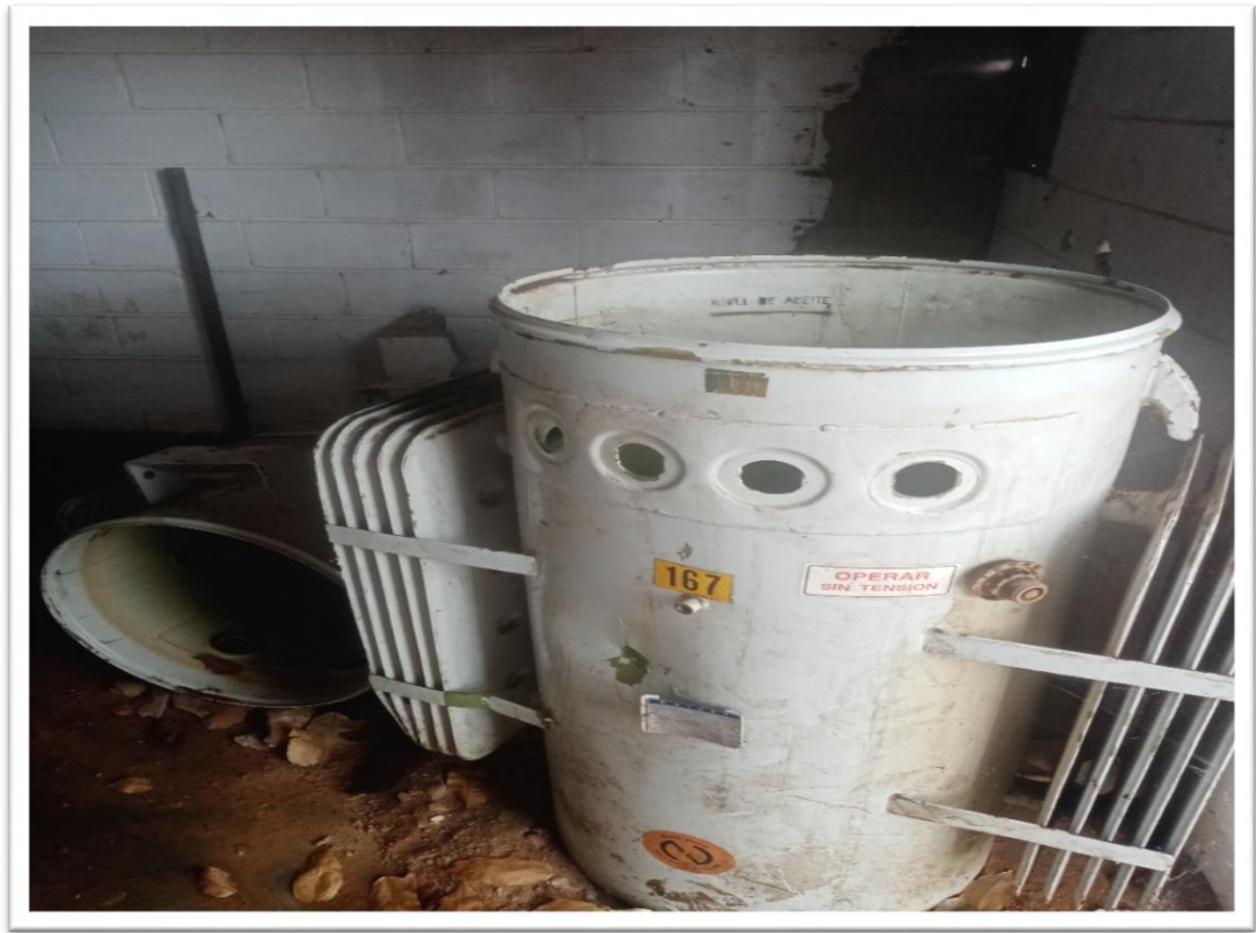
Fig 5.3 Estado del banco de transformadores que daban la tensión de energía a la edificación de cursos básicos. Fuente: Tomada de Visita de campo, 2022.
