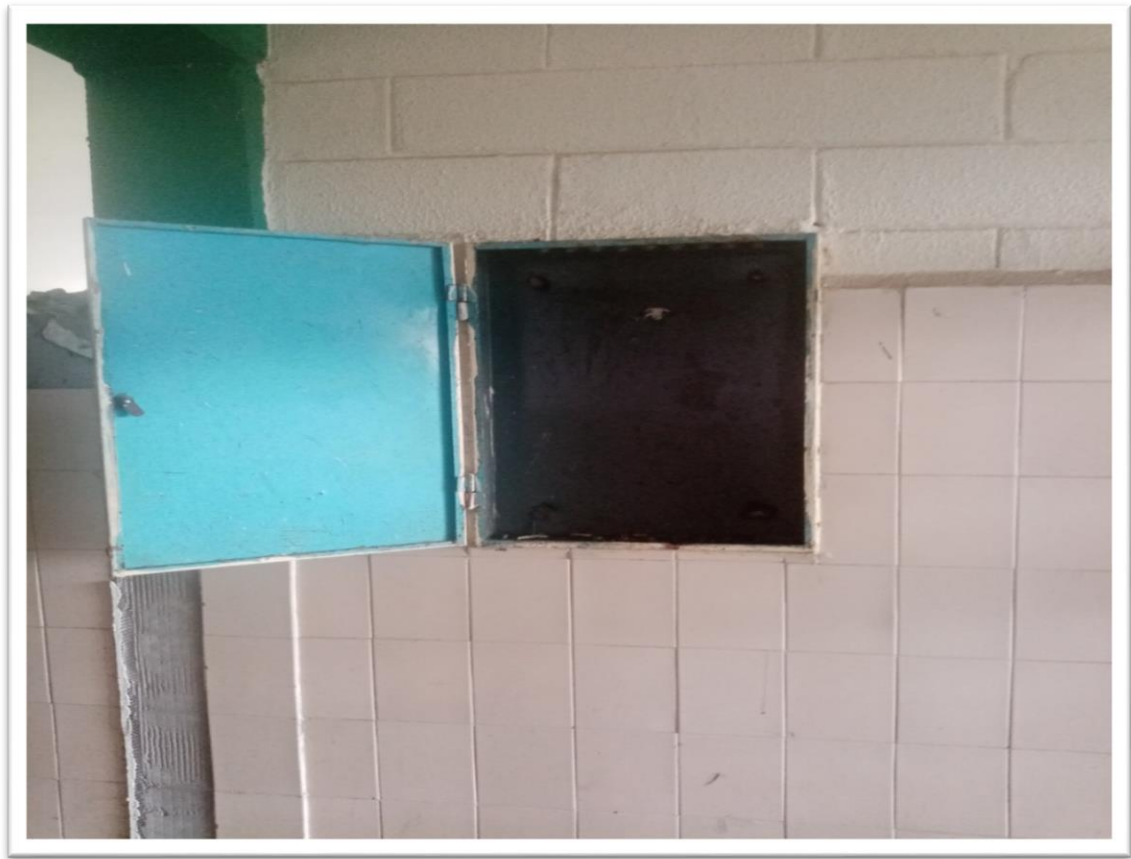
Fig 5.4 Condición del tablero eléctrico del segundo nivel de la edificación. Fuente: Tomada de Visita de campo, 2022.
