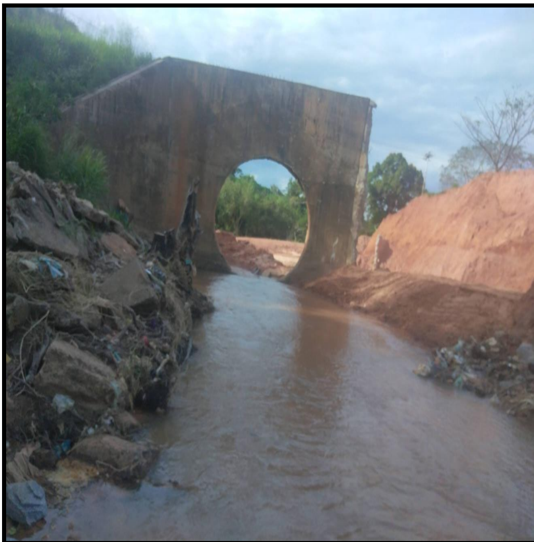
Figura 1.2. Corte de la viabilidad por derrumbe del viaducto. Fuente: Trabajo de campo del Autor. 2022.
