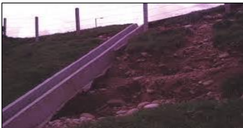
Figura 6.3 Ejemplo de torrentera socavada por las aguas de escorrentía.
