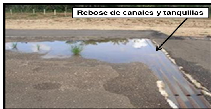
Figura 9. Problemas y fallas presentes en la LOC. J Fuente: PDVSA (2007)
