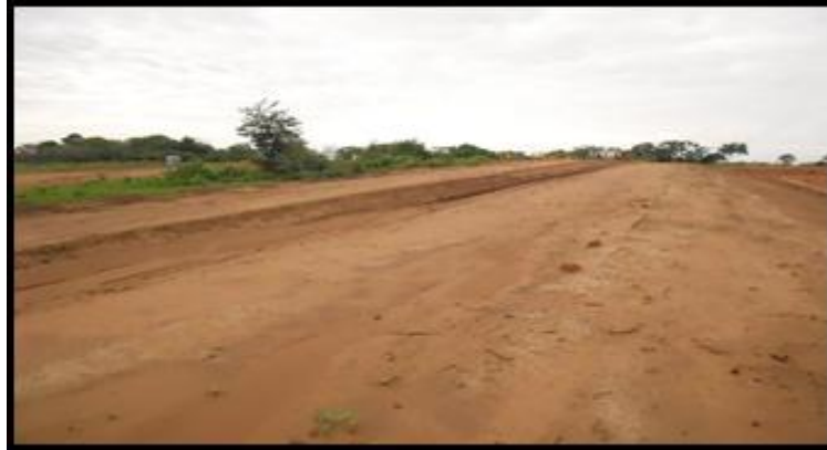
Figura 12. Cuneta corona. Fuente: Autor
