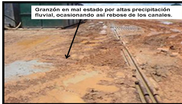
Figura 7. Problemas y fallas presentes en la LOC. JK-Q Fuente: PDVSA (2007)
