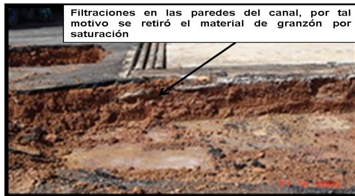
Figura 5. Problemas y fallas presentes en las Loc. AZ-W Fuente: PDVSA
