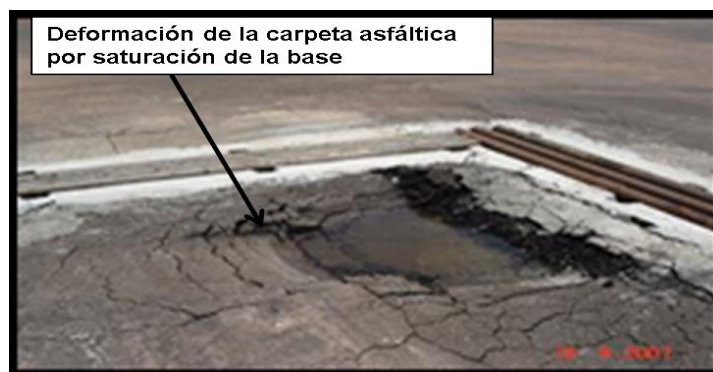
Figura 6. Problemas y fallas presentes en las Loc LOC. AD-A Fuente: PDVSA
