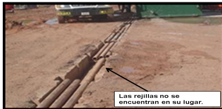
Figura 4. Problemas y fallas presentes en las Loc. Toco profundo Fuente: PDVSA (2005)
