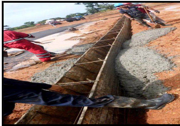
Figura 23. Vaciado del concreto en las paredes del canal. Fuente: Gerencia de construcción, PDVSA
