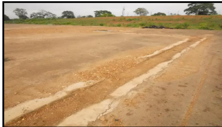
Figura 17. Sistemas de drenajes tapados Fuente: Autor
