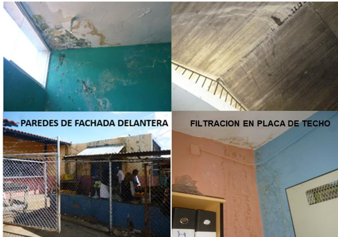
Figura 9. Patologías presentes en el Mercado Municipal. Fuente: Autor.
