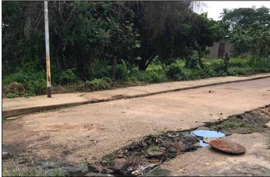
Figura 23. Boca de visita de la red aguas negras desbordada luego de la ocurrencia de precipitaciones, ubicada en la calle Monagas.
