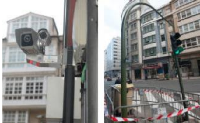
Figura 2. Cámara ya instalada en cordonería y soporte donde se ubicará un sistema fotorrojo
