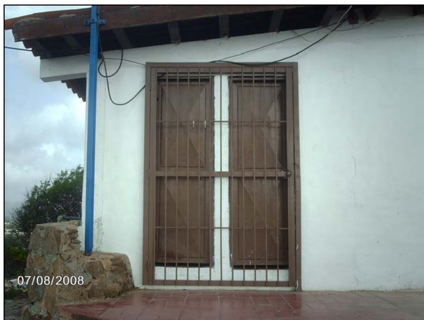
Baños del Fortín cerrados porque están dañados y en mal estado
