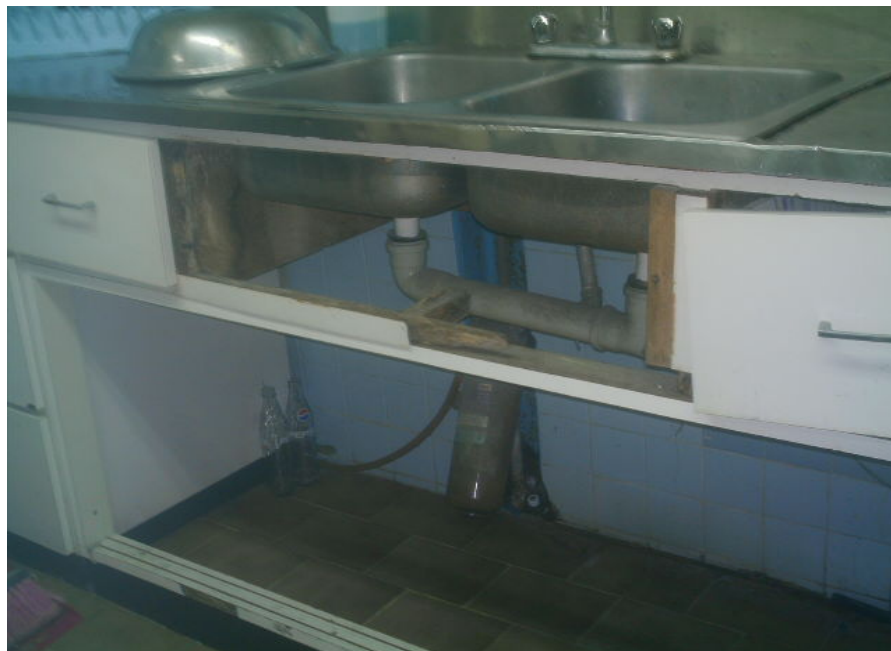
Área del lavado de material: fregadero en malas condiciones y acumulación de basura.
