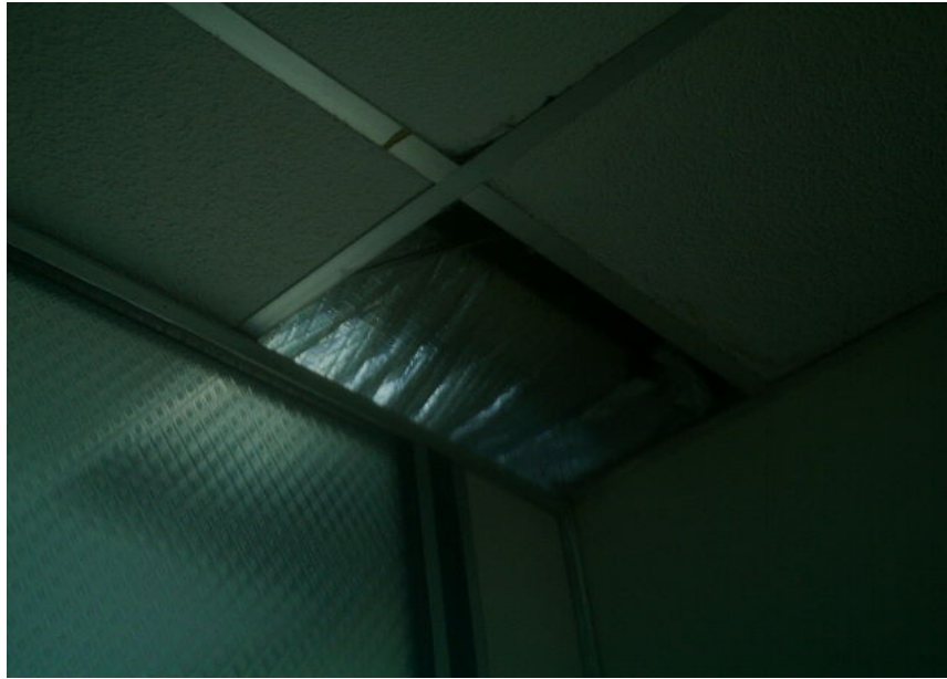
Área de oficina techo en mal estado.
