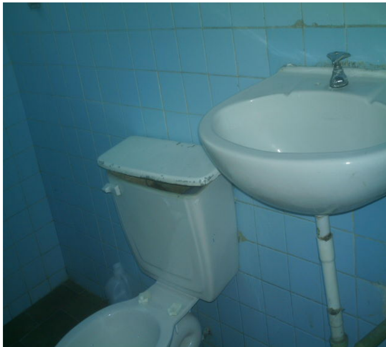
Sanitarios en malas condiciones
