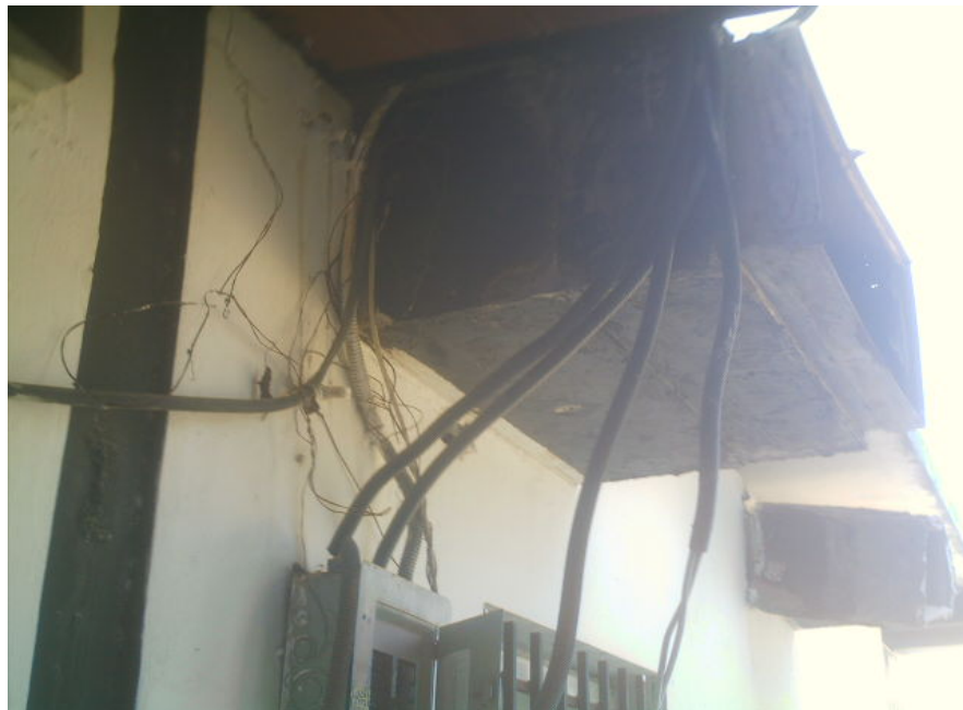
Área de recepción cableado desprotegido
