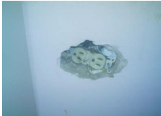
Falta de cajetín de electricidad.
