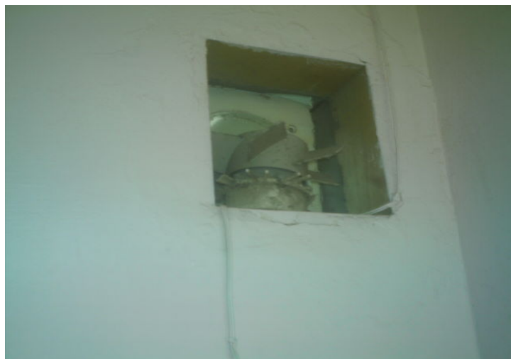
Cuarto de los auxiliares: ventilación deficiente
