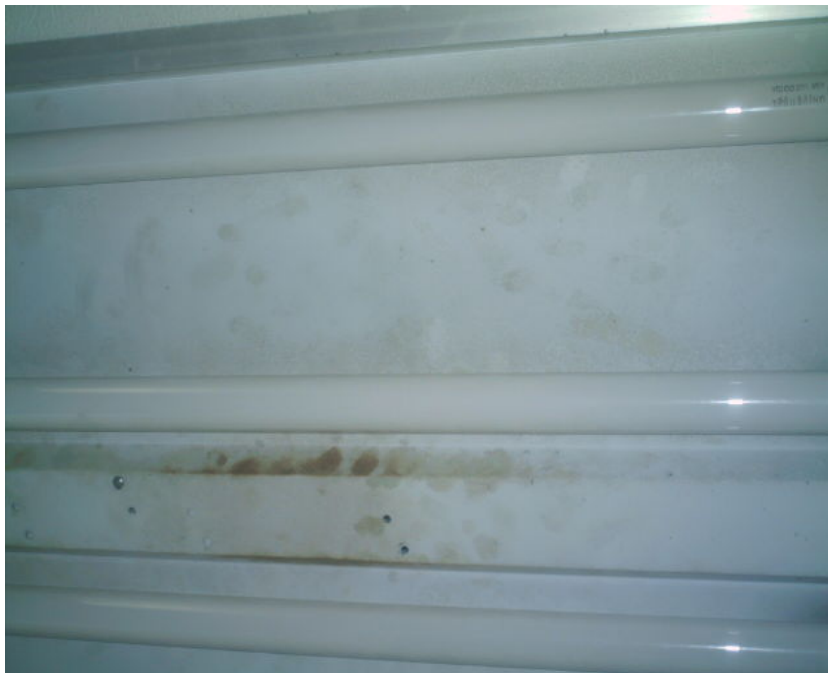
Área de oficina: escasez de lámparas.
