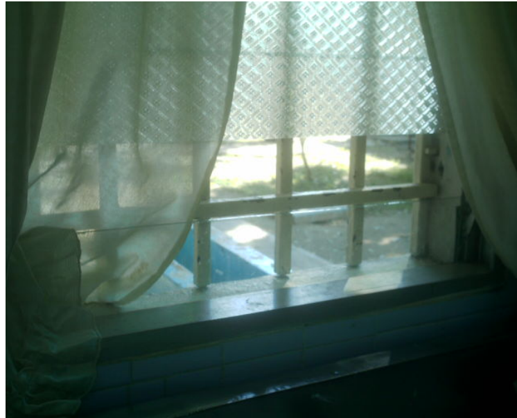
Falta de vidrios en ventanas.
