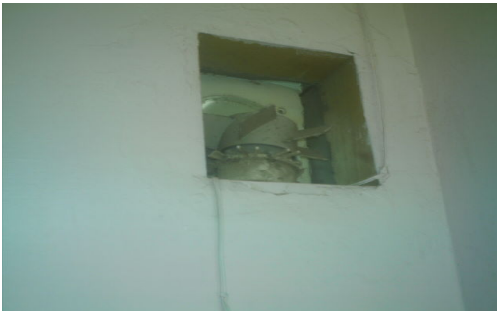
Figura 4.10. Cuarto de auxiliares.
