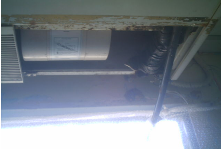
Aires acondicionados defectuosos.
