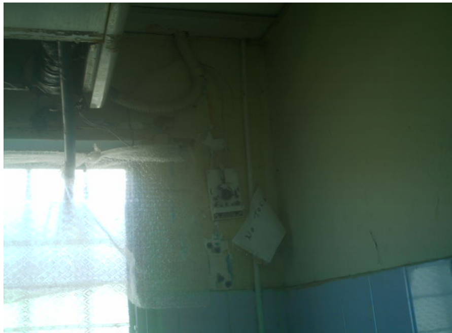
Área de orina y heces: cableados desprotegido y aires acondicionados defectuosos.
