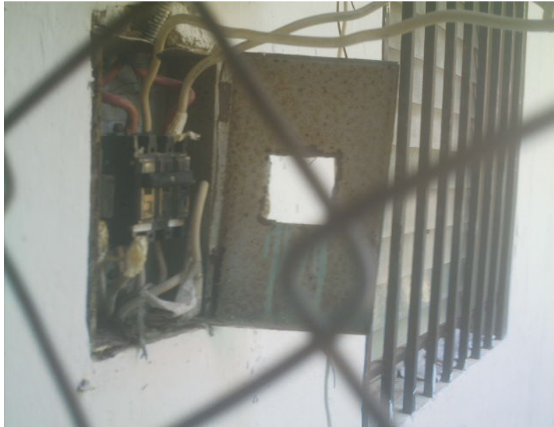
Área de recepción cableado desprotegido.
