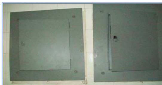
Figura 4.69. Cajetin de electricidad.
