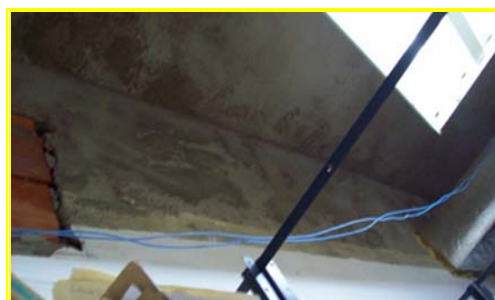
Figura 4.7. Techo de concreto con humedad.
