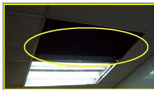
Figura 4.5. Falta de lámina de plafón de anime.
