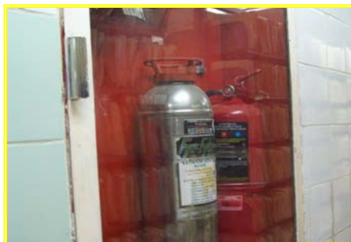
Figura 4.36. Extintor de incendios del Archivo principal.
