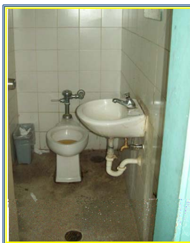
Figura 4.18. Condiciones actuales del baño.
