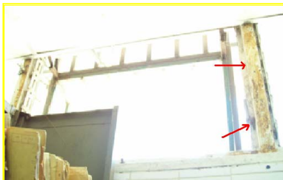
Figura 4.16. Ventana utilizada por insectos para entrar y donde se percibe la falta de mantenimiento y cría de éstos.
