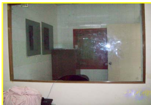
Figura 4.68. En la fachada de la secretaría de sala de parto se observa la carencia de ventilación y lamparas.
