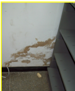
Figura 4.28. Presencia de humedad en el Archivo pasivo.
