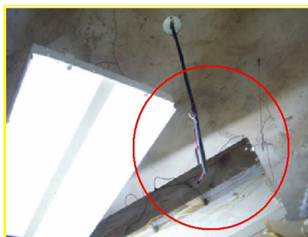
Figura 4.21. Cables dañados y guiando.
