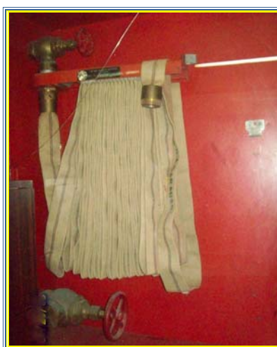
Figura 4.72. Manguera contra incendio
