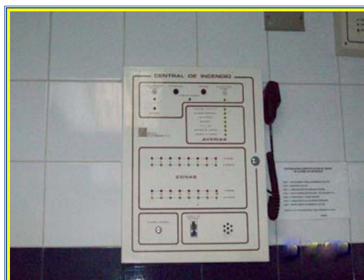
Figura 4.58. Central de incendio.
