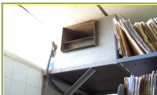
Figura 4.14. Aire acondicionado dañado que puede ser utilizado para la cría de insectos.
