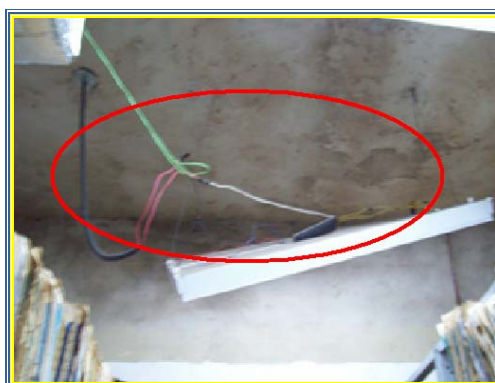
Figura 4.20. Cables con lámparas guiando.
