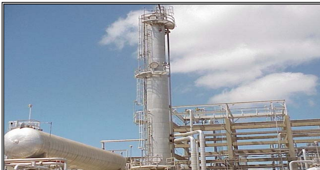
Figura 3.11 Torre estabilizadora de Condensados
