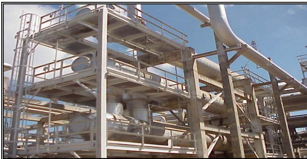
Figura 3.5 Intercambiador gas caliente/gas de alta presión.
