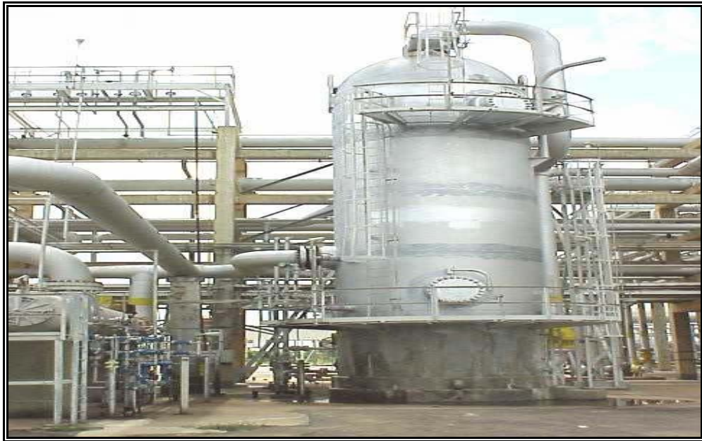
Figura 3.4 Torre Contactora de Trietilenglicol.
