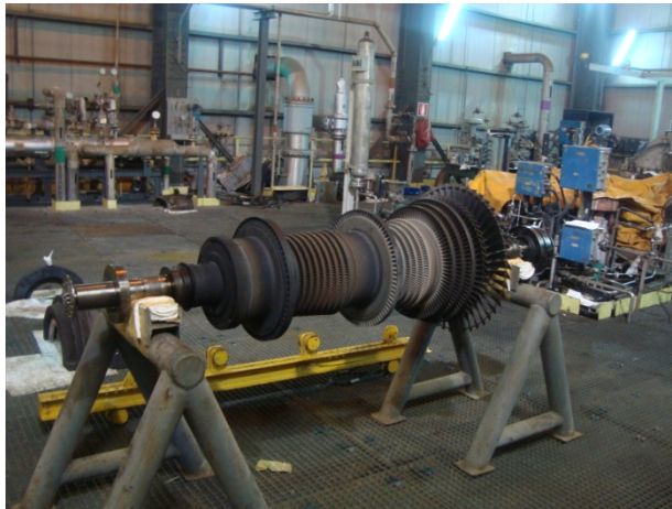
Figura 2.3. Turbina de gas de síntesis (12-TK-431)
