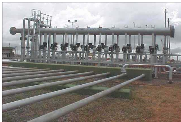
Figura 2.1. Líneas de flujo que convergen al múltiple de producción
