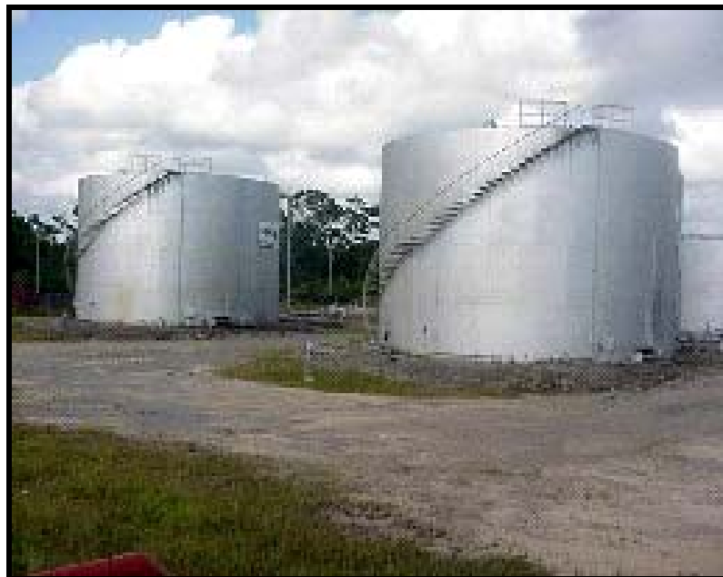
Figura 2.4. Tanques de almacenamiento de la estación La Ceibita principal (Fuente: PDVSA Gas).
