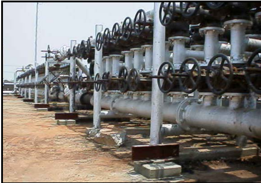
Figura 2.2. Múltiple de producción de la estación L-63 (fuente: PDVSA Gas).
