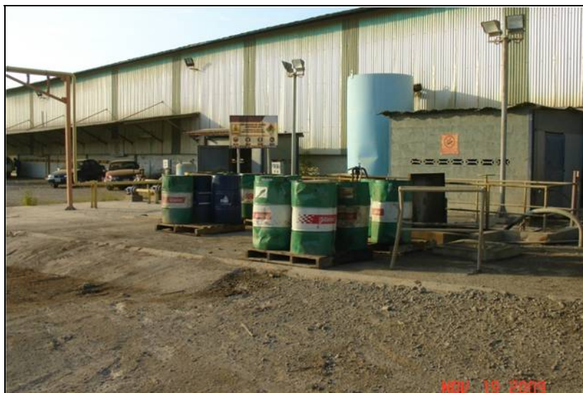
Figura 4.23 Sistema de tratamiento de Equipo Pesado.
