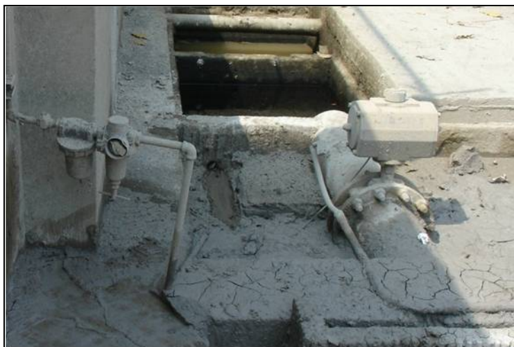
Figura 4.19 Fosa de la tubería de admisión al desarenador de Equipo Liviano.
