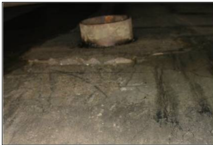
Figura 4.20 Tubería de entrada a la fosa de hidrocarburos de Equipo Liviano.
