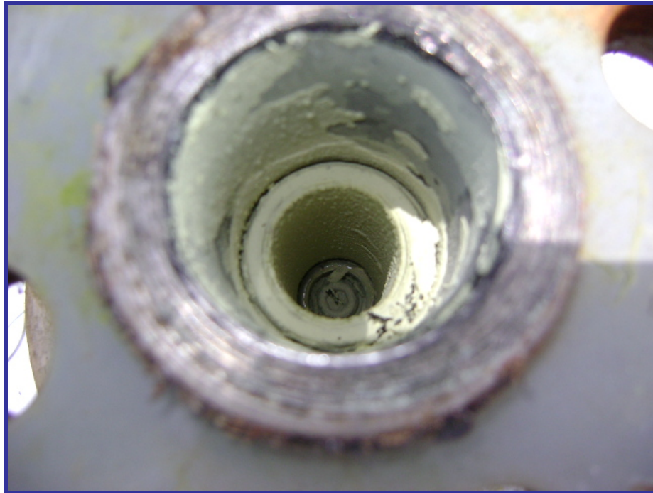
Figura 3.9.- Presencia de Azufre Elemental en el interior de Válvula Reguladora.
