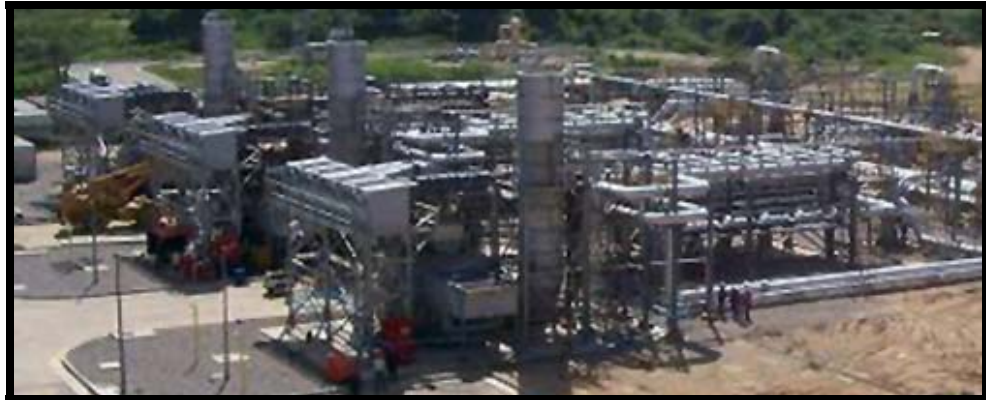
Figura 2.3 Planta de compresión de gas
