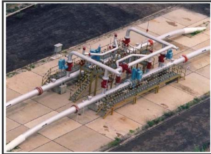
Figura 2.2 Estación de Válvulas
