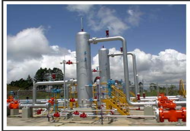
Figura 2.5 Estación de regulación primaria.
