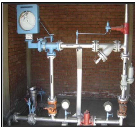
Figura 2.6 Estación de medición y regulación.
