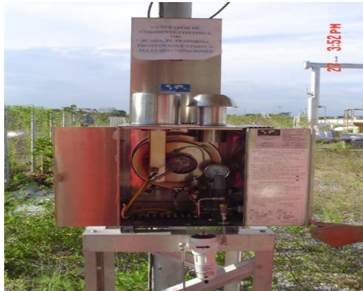
Figura 3.13 Muestra una pila térmica ya instalada en campo
