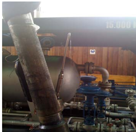
Figura 3.6 Válvula recuperada sometida a 5.000 psi aplicado en la tubería de producción.
