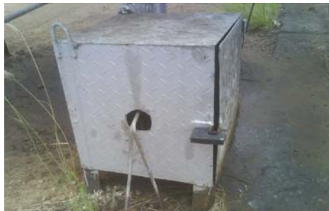
Figura 3.8 Caja metálica que resguarda la bomba dosificadora para evitar el robo de la misma.
