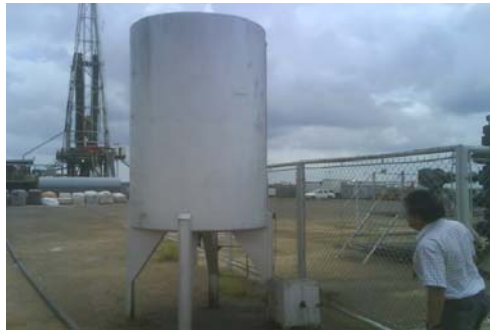
Figura 3.9 Tanque de almacenamiento de química.
