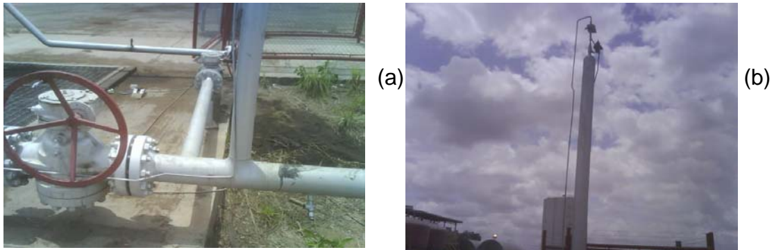
Figura 3.11 (a) Base al depurador conectado a la sarta de producción; (b) Parte superior del depurador donde se muestra la tubería de salida del gas limpio para suministrar la bomba
