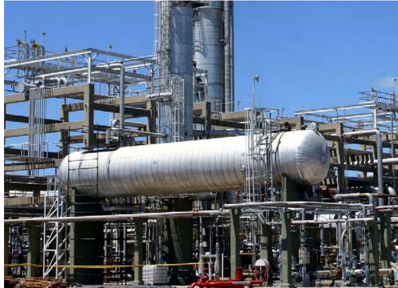
Figura 25. Separador bifásico horizontal
