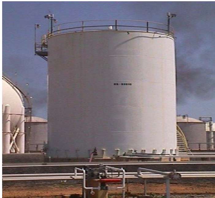
Figura 21. Tanque de techo cónico
