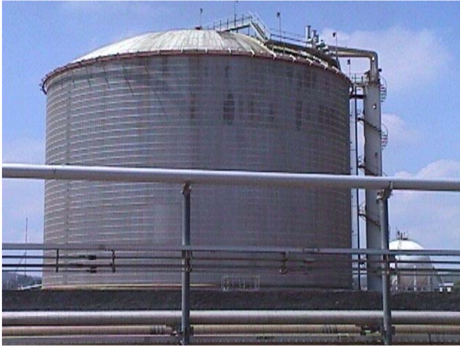
Figura 23. Tanque de almacenamiento de isobutano a 12°F y 1 psi
