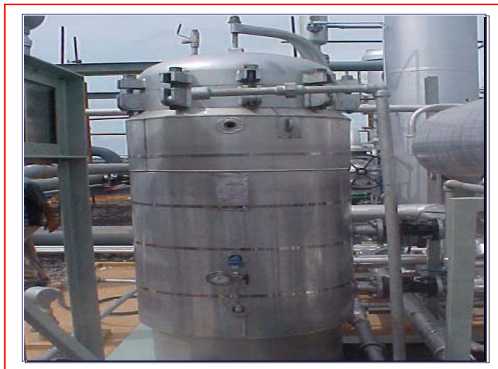
Figura 2.12. Filtro de carbón activado.
