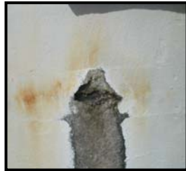
Figura 3. Perforación en el tanque de almacenamiento de NaOCl.
