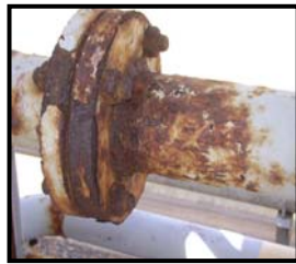
Figura 6. Tubería-brida corroída (Unidad 41, agua de servicio).
