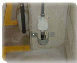
Figura 32. Sistema de detección y alarmas
