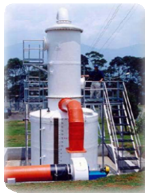
Figura 33. Torre de absorción
