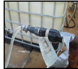
Figura 4. Fuga de hipoclorito de sodio (unidad de aguas residuales).
