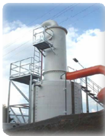
Figura 34. Tanque para la solución neutralizadora.
