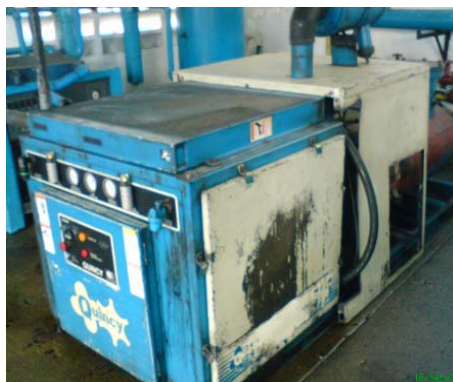
Figura 2.14 Compresores Quincy QMA-75
