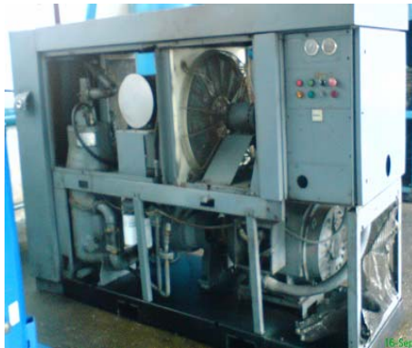
Figura 2.16 Compresor Quincy QSF-100
