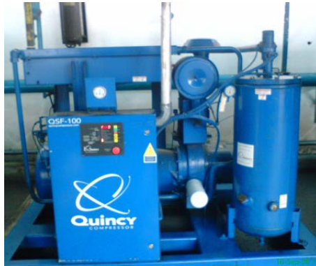
Figura 2.15 Compresor Quincy QSF-100
