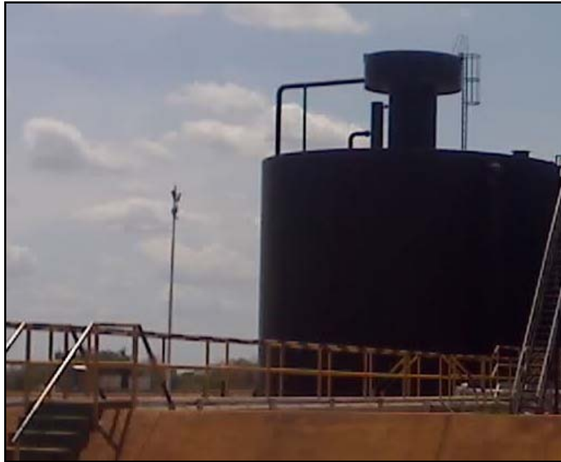
Figura 2.25 Tanque de lavado.
