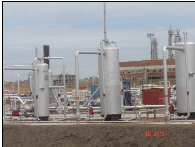
Figura 2.28 Equipo de separación gas-petróleo.
