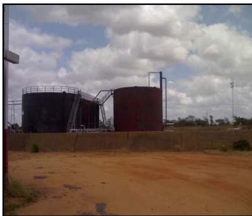
Figura 2.11 Estación de descarga BA-01.
