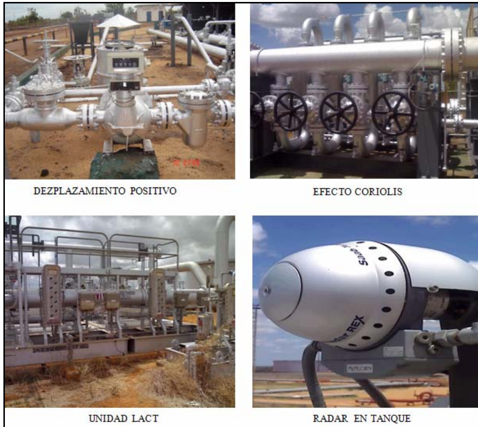
Figura 3.10 Equipos de medición de volumen de crudo
