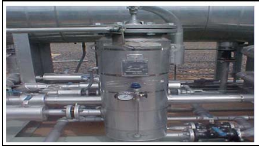
Figura 4.8. Filtro de cartucho presente en el proceso de regeneración del glicol
