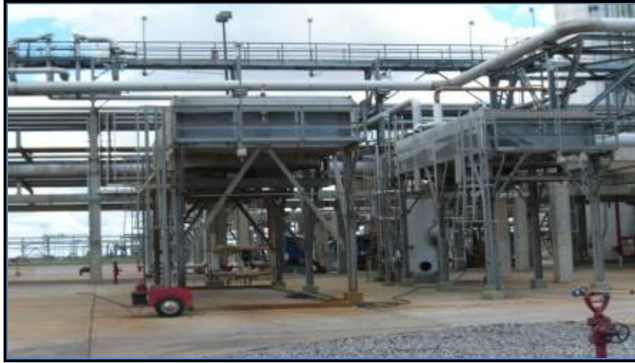
Figura 4.7. Equipo de enfriamiento por aire
