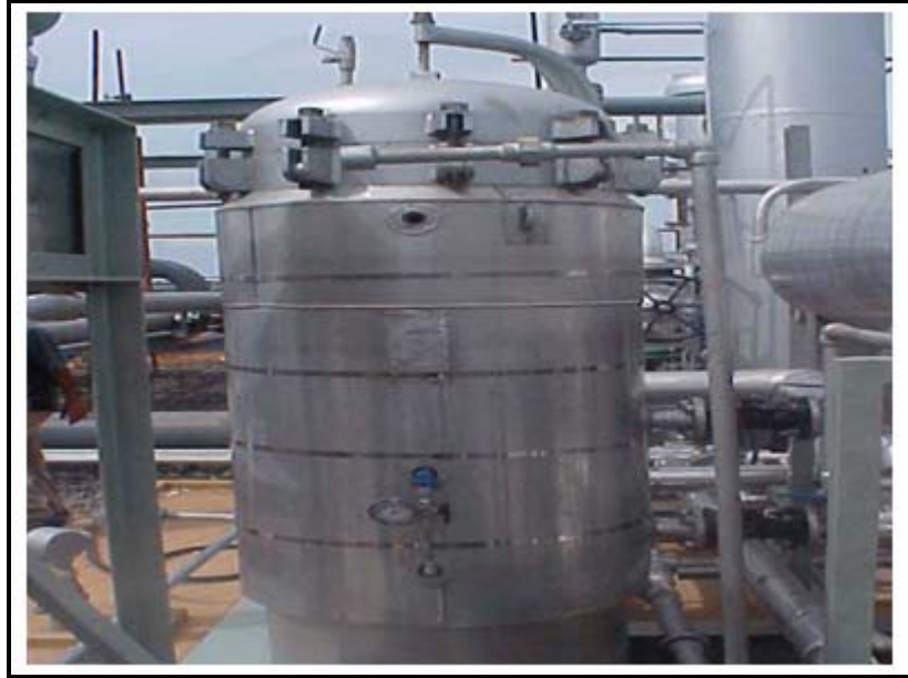
Figura 4.9. Filtro de carbón activado
