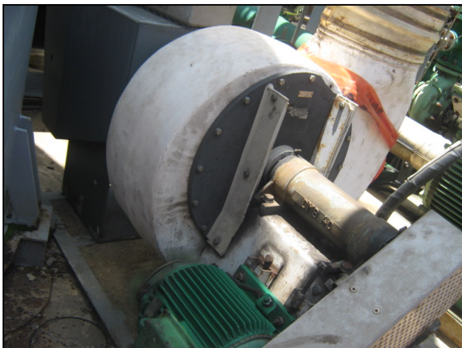
Figura 4.29 Soplador usado en el retrolavado de los filtros con carbón activado
