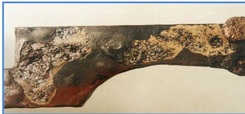
Figura 2.22 Corrosión por Exfoliación. [5]
