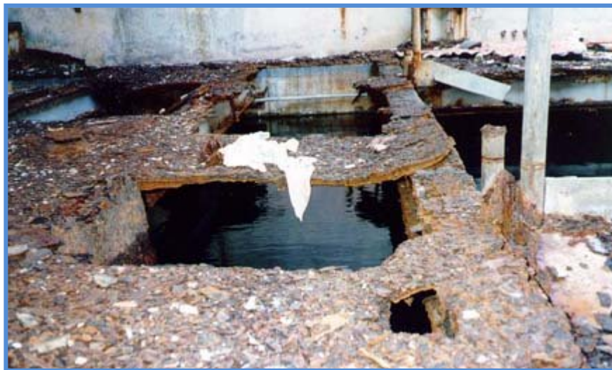
Figura 2.18 Corrosión Uniforme en acero estructural [9]
