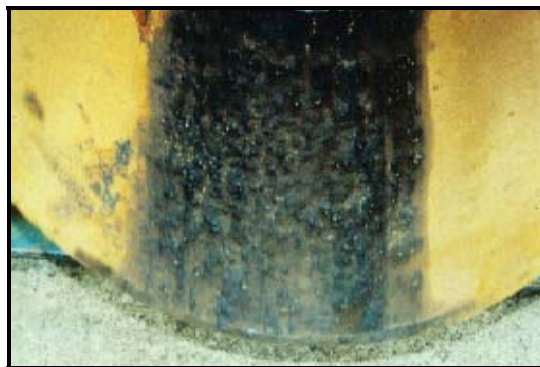
Figura 2.19 Corrosión interna en gasoductos.
