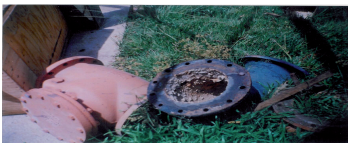
Figura 1. Vista parcial de un codo de 90° con diámetro exterior de 12 pulgadas, fuertemente incrustado con carbonato de calcio, en la planta de tratamiento Angostura Ciudad Bolívar.
