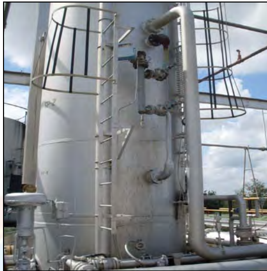
Figura 2.7 Separador vertical de producción en la estación de flujo de Orocuál
