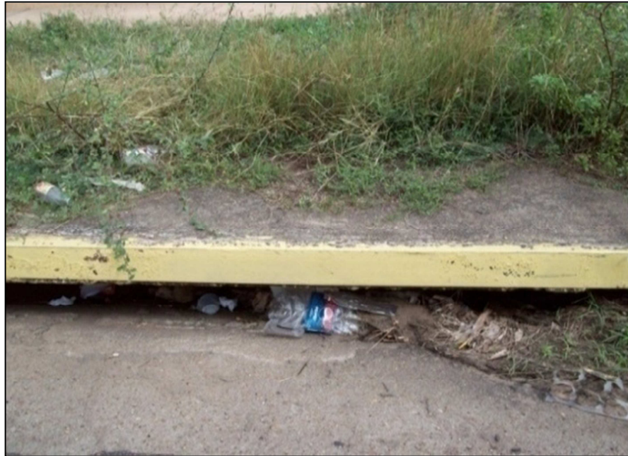
Figura 5.11 Sumidero en la avenida Alejandro Vargas.
