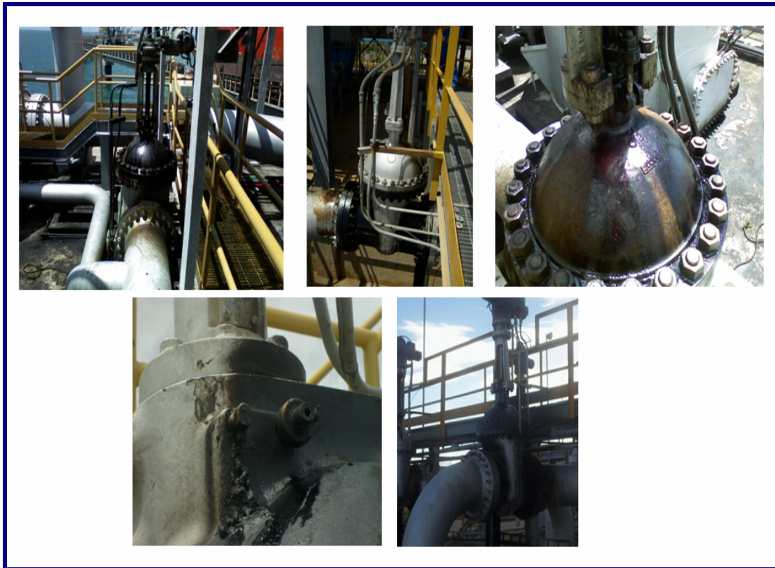
Fig. 4.1 Evidencias de fugas en válvulas de la línea de la plataforma sur [PDVSA].
