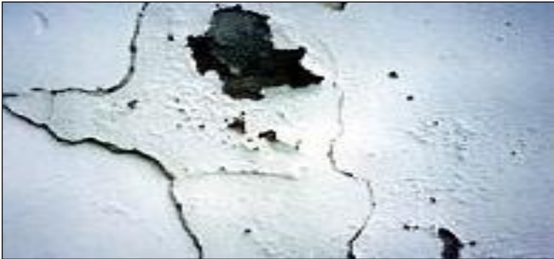
Figura 4.5 Agrietamiento y desconchado de pintura ( www.rastrodelapintura.com )
