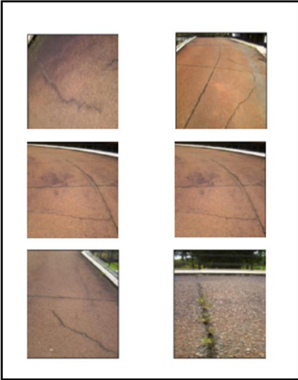
Grietas transversales, longitudinales y en pavimento; diagonales y deficiencia en sello de juntas de pavimento.
