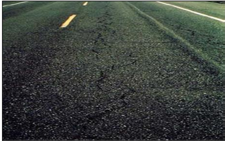
Figura 3.24 Grieta longitudinal. (Corredor G., 2008)
