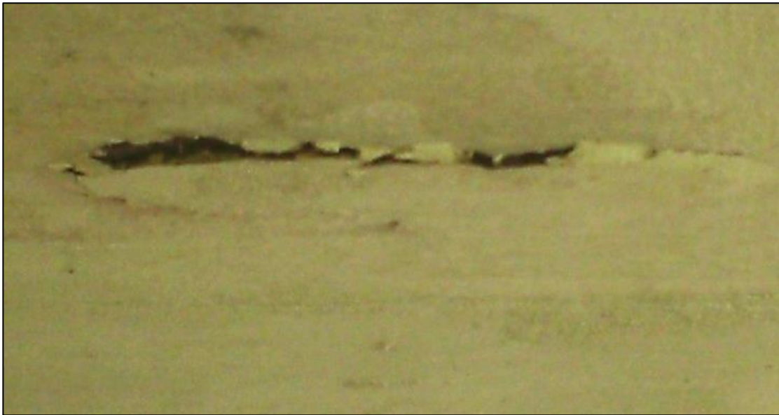
Figura 5.8 Desprendimiento y agrietamiento del recubrimiento de concreto en losa
