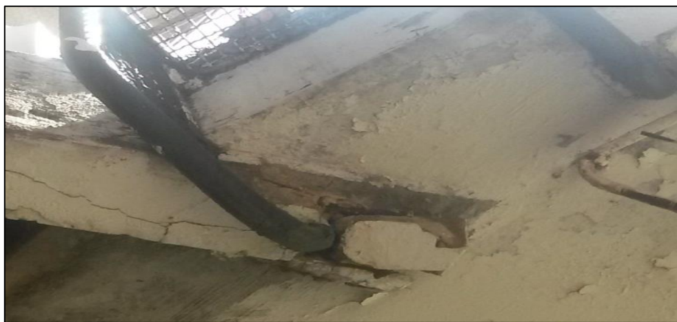
Figura 5.9 Desprendimiento de concreto en el anclaje de baranda a losa
