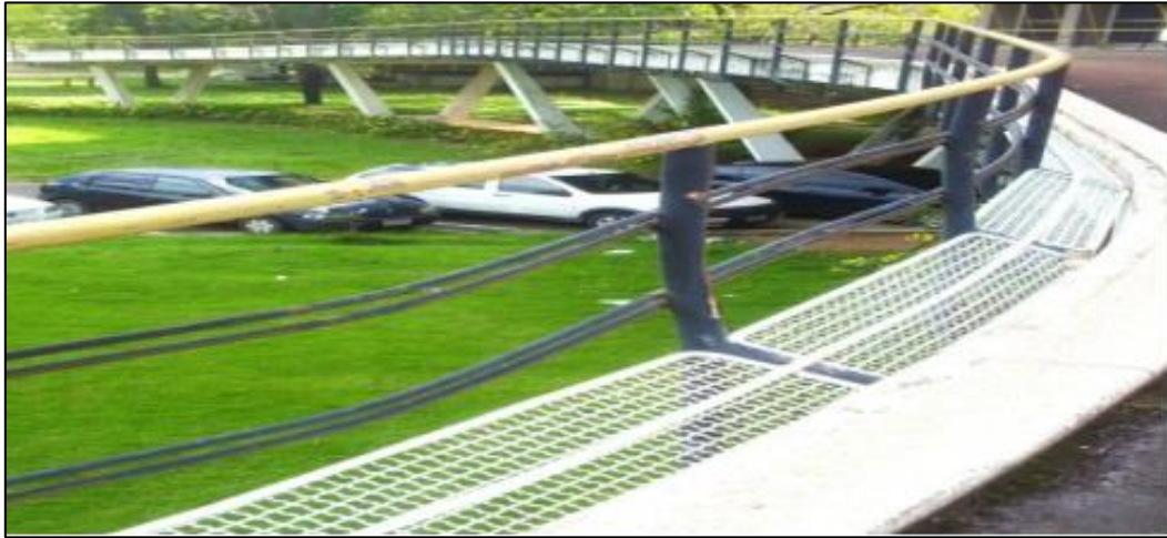
Figura 5.13 Deformaciones en baranda metálica ocasionadas por vehículos
