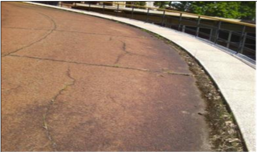
Figura 5.11 Deficiencia en material de sello de las juntas transversales del pavimento
