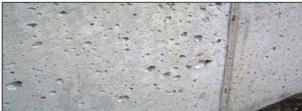
Figura 3.20 Burbujas superficiales en elemento de concreto. (lmcc.com).
