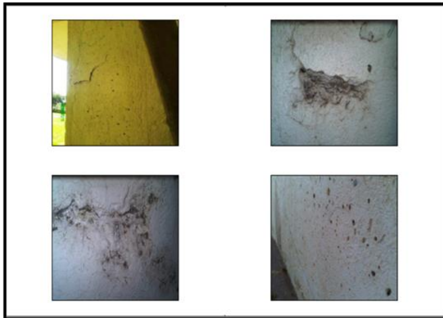
Oquedades, burbujas superficiales y coqueras
