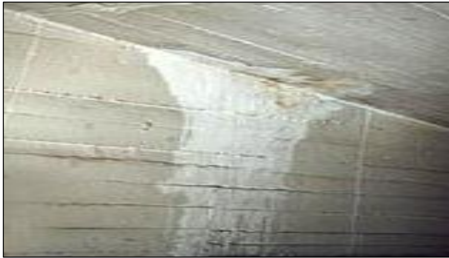
Figura 4.3 Presencia de humedad ( www.rastrodelapintura.com )
