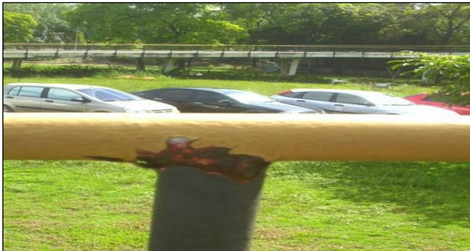
Figura 5.12 Presencia de corrosión en baranda Metálica de la rampa
