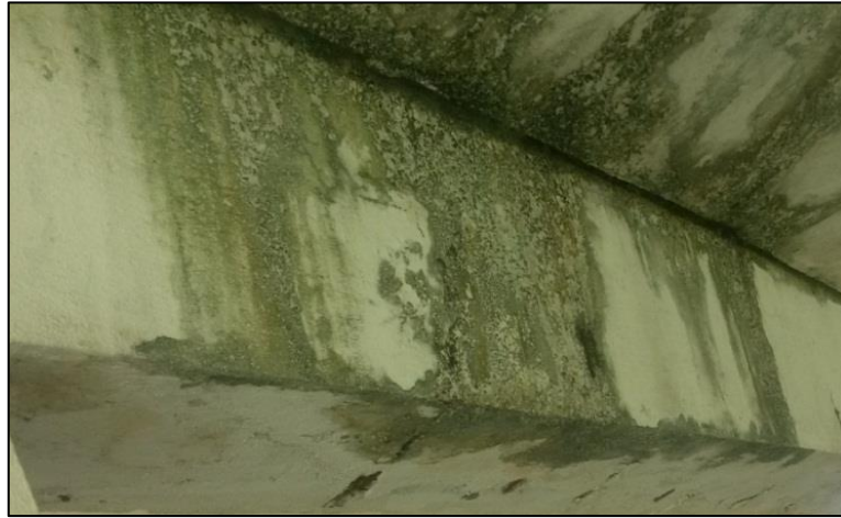
Figura 5.5 Manchas de humedad y presencia de moho
