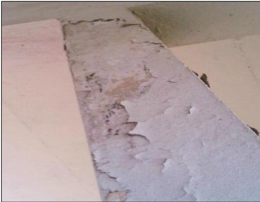
Figura 5.7 Desconchamiento de la pintura
