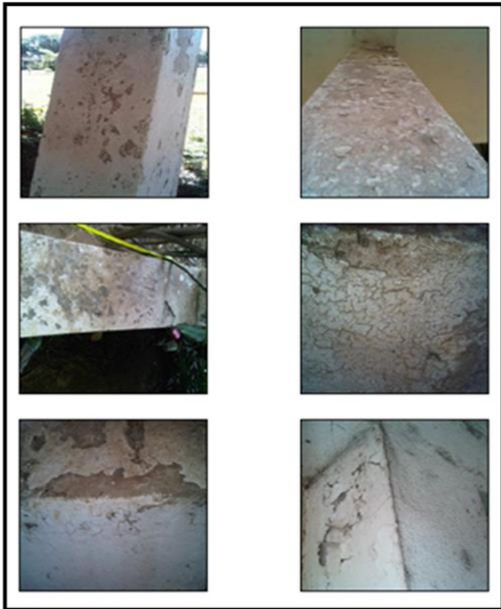
Desconchado y cuarteado de la pintura
