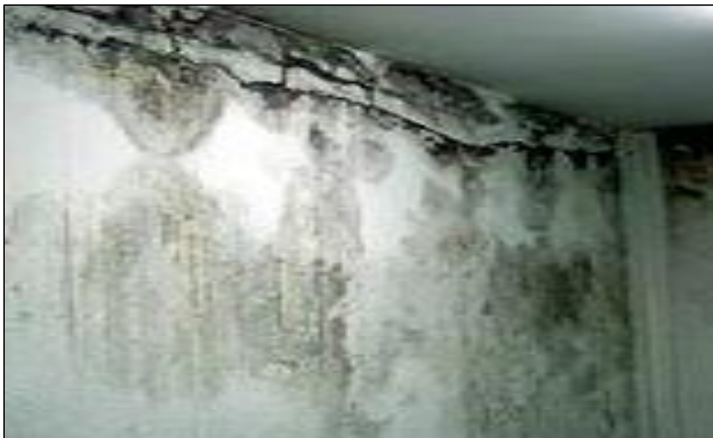
Figura 4.4 Presencia de moho en muro ( www.rastrodelapintura.com )
