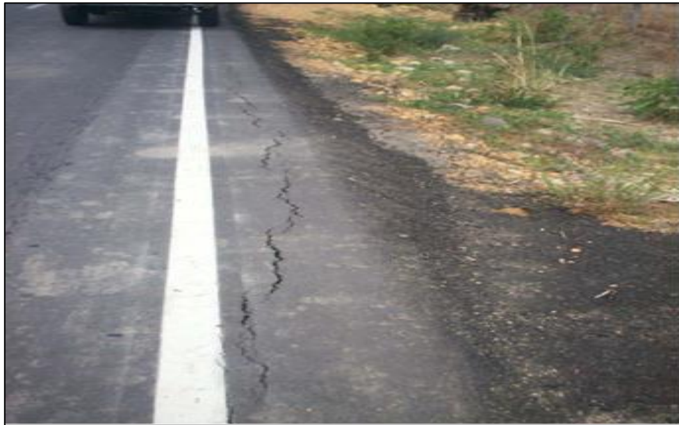
Figura 3.22 Grieta de borde. (Corredor G., 2008).
