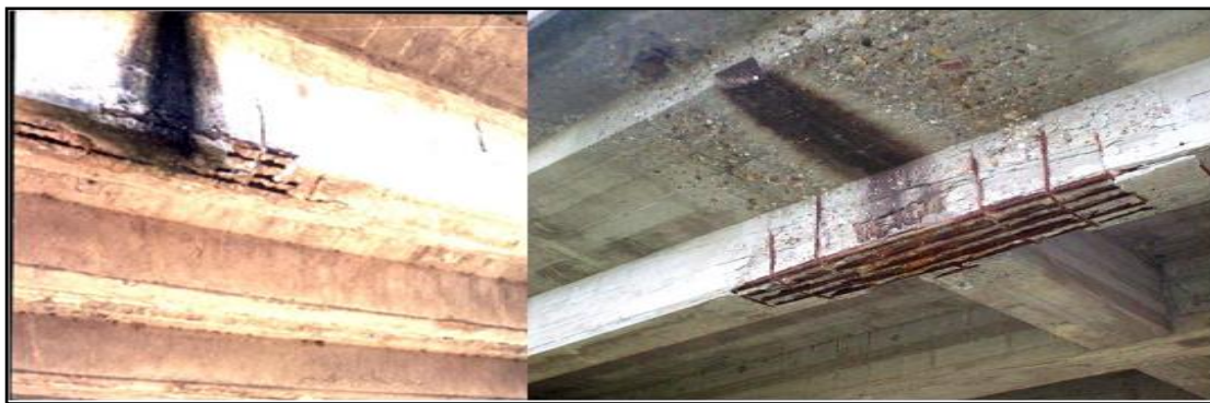
Figura 4.2 Daños causados por desagües sin saliente inferior(MOSP, 2007)
