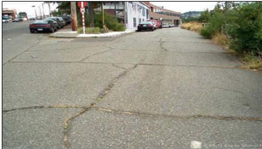
Figura 3.23 Grieta por reflexión de juntas. (Corredor G., 2008).
