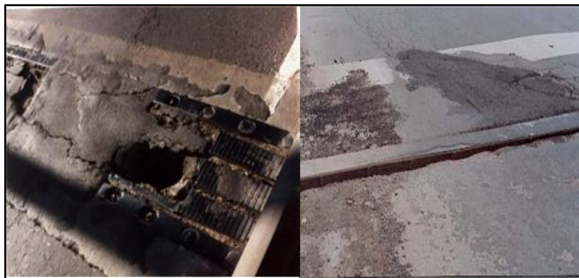
Figura 4.1 Fallas en juntas de dilatación (MOSP, 2007)
