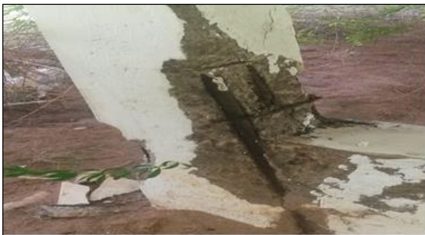
Figura 5.3 Exposición de acero de refuerzo en viga de pilar
