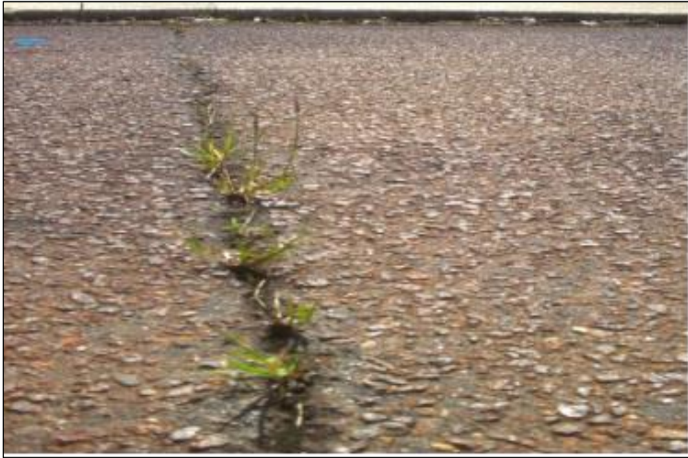
Figura 5.10 Grietas longitudinales en pavimento lado derecho
