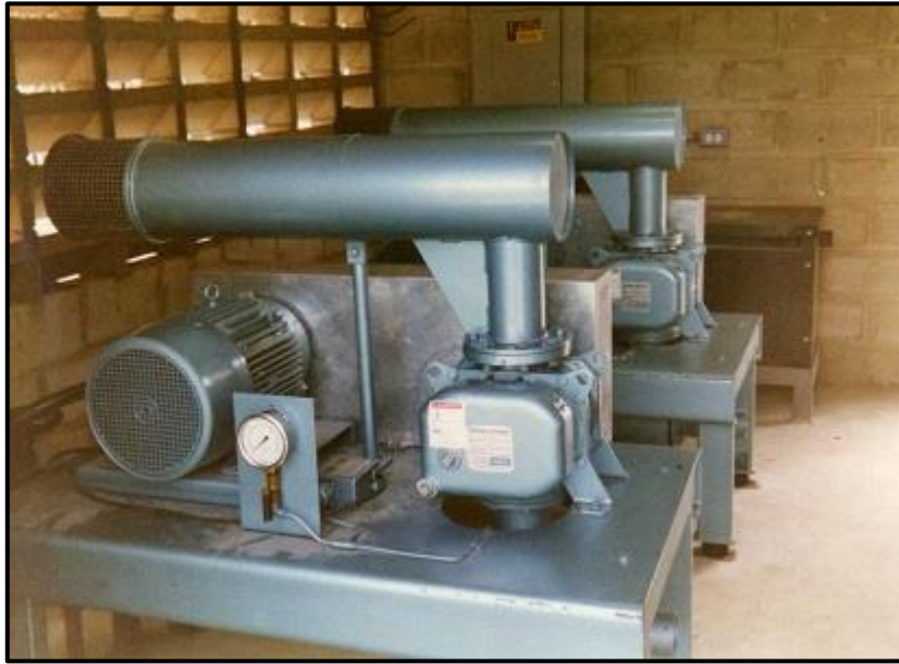
Figura 3.31 Sopladores de aire.
