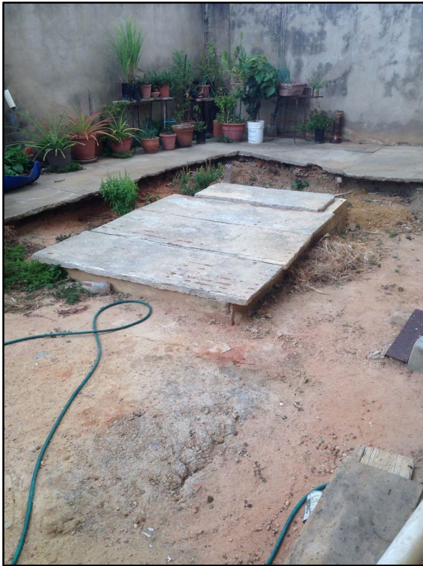
Figura 9.30 tanque de infiltración del sistema de pozo séptico de una vivienda de la urbanización Canta Claro.
