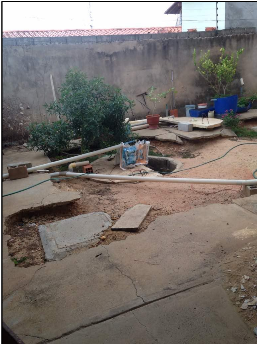
Figura 9.28 instalaciones del pozo séptico de una vivienda de la urbanización Canta Claro.
