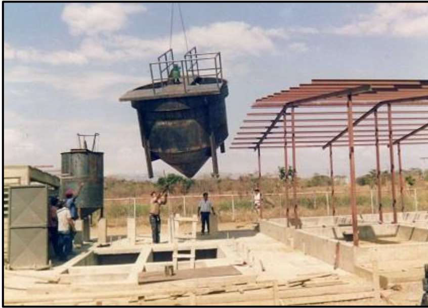
Figura 3.25 Tanque sedimentador metálico.
