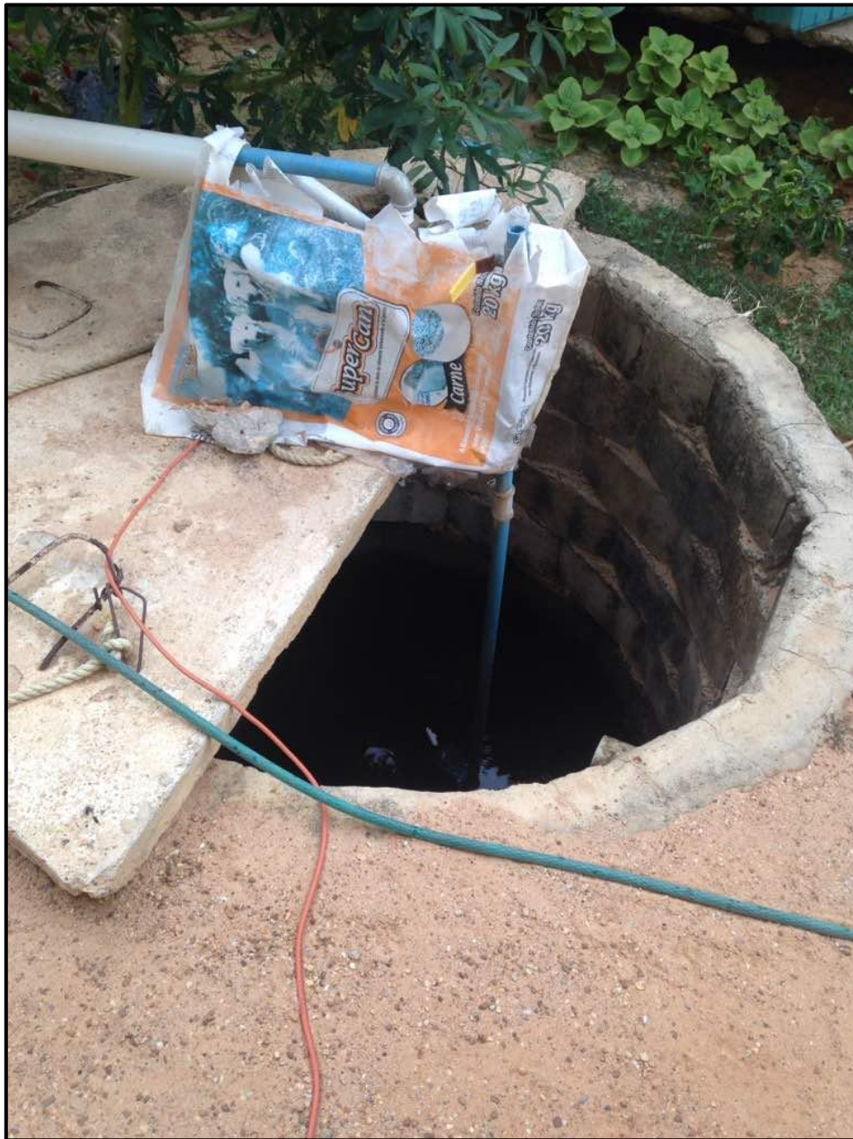
Figura 9.29 fosa séptica de una vivienda de la urbanización Santa Claro.
