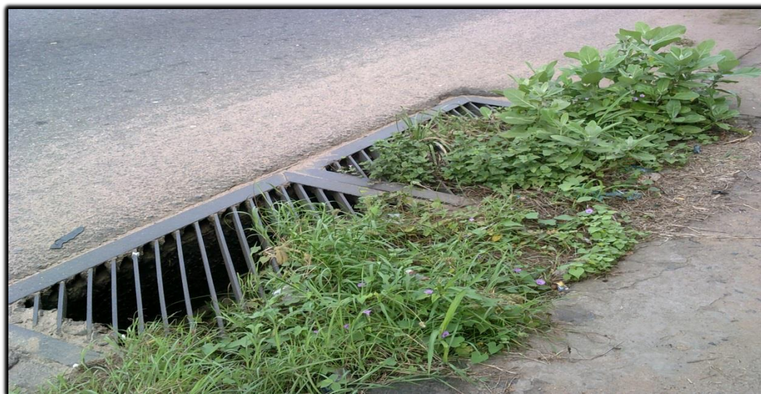
Figura 5.1 Sumidero de rejas existente en la zona ubicado en frente del establecimiento Autopartes Guayana C.A
