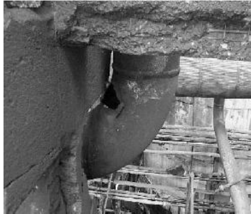
Figura 2.2 Daño por sulfidación en el codo de una tubería (API 571, 2003).
