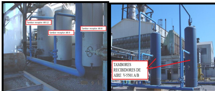
Figura 3.5 Condiciones de los tambores receptores AR-8/9 /12 y V-5501 A
