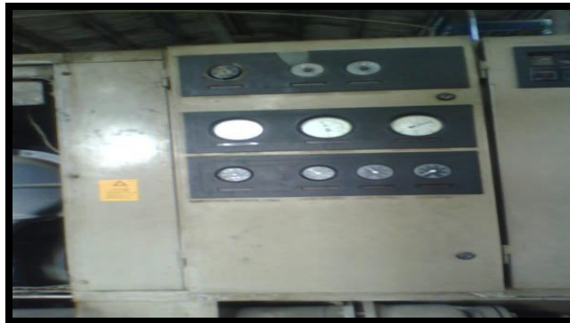
Figura 3.2 Condición actual del panel de la unidad compresora GB-3
