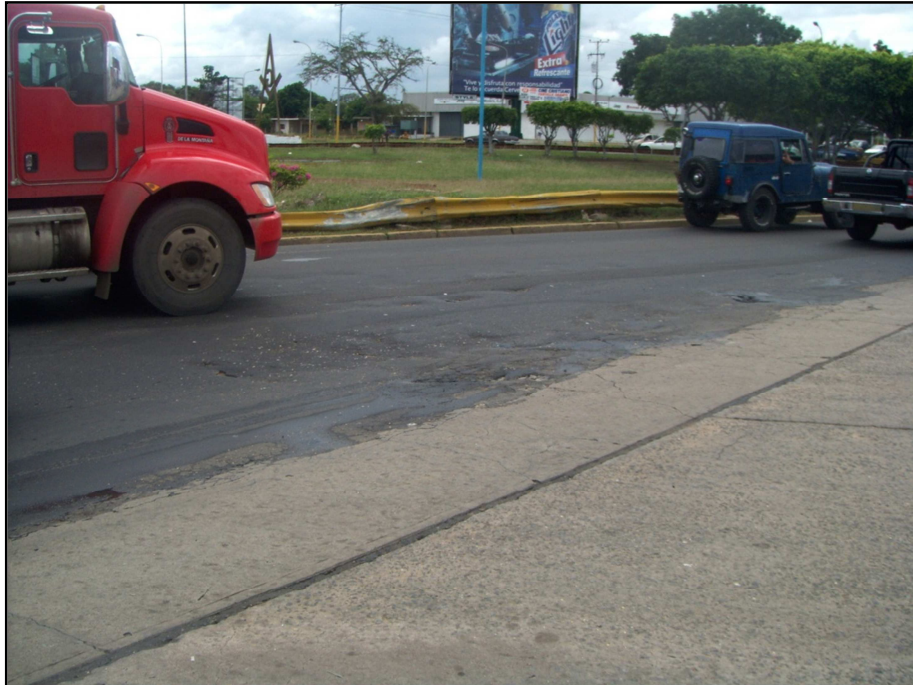
24. Condiciones de la vía.
