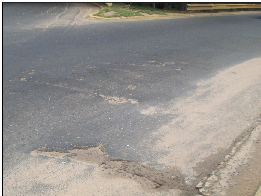
23. Condiciones de la vía. Sentido E
