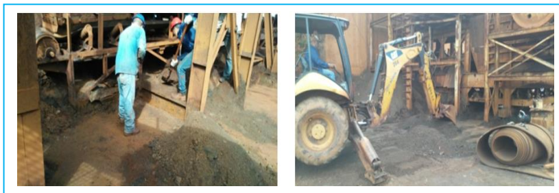
Figura 4.41 Descongestionamiento de planta de trituración (Centeno, 2017).
