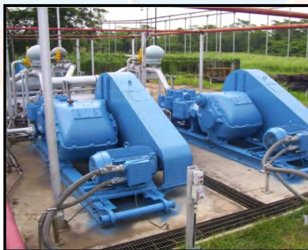
Figura N° 2.8. Bombas de crudo. Fuente: PDVSA, Petrodelta (2012).
