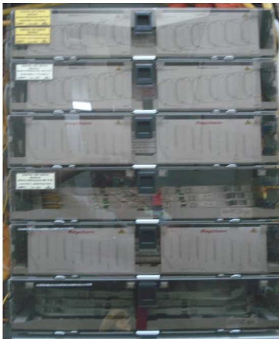
Figura. 3.14. Distribuidor de fibra óptica (ODF). Fuente CANTV
