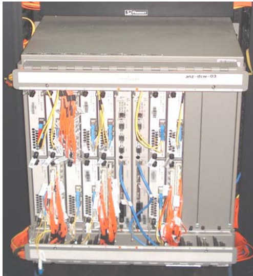
Figura. 3.12. Router. Fuente CANTV [12]
