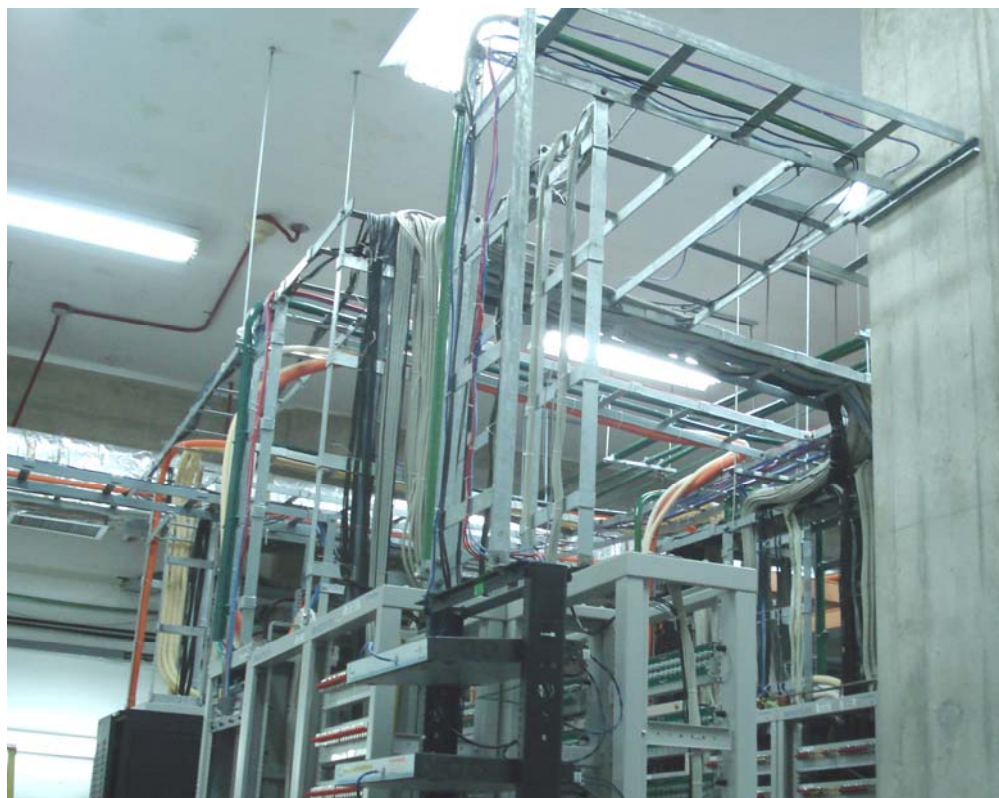
Figura. 4.10 Escalerilla metálica de paso. Fuente CANTV
