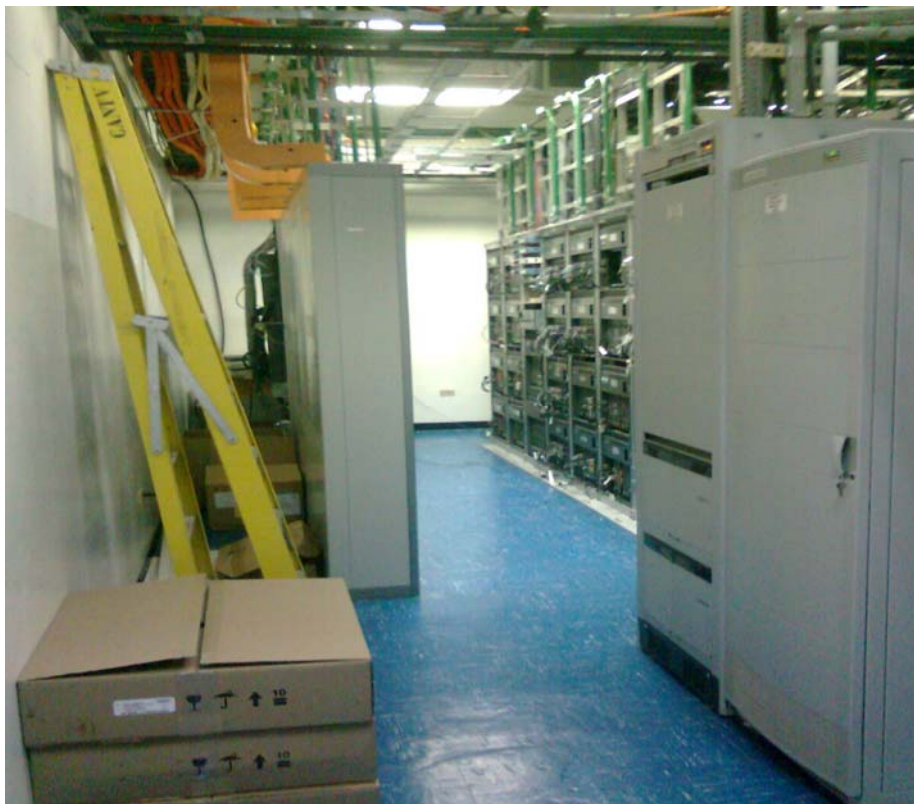
Figura. 3.9. Sala de Datos. Fuente CANTV.
