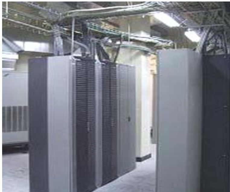
Figura. 3.21. Sala Conmutación. Fuente CANTV
