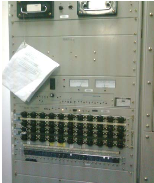
Figura. 3.15. Distribuidor de Energía (PDB). Fuente CANTV
