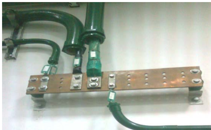
Figura. 4.23. Barra de Puesta a Tierra. Fuente CANTV
