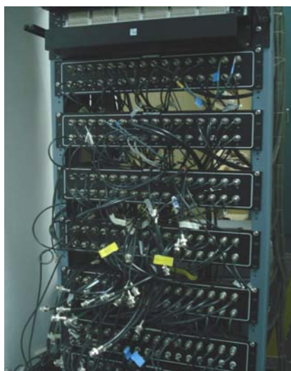
Figura. 3.13. Distribuidor de Cable coaxial. Fuente CANTV
