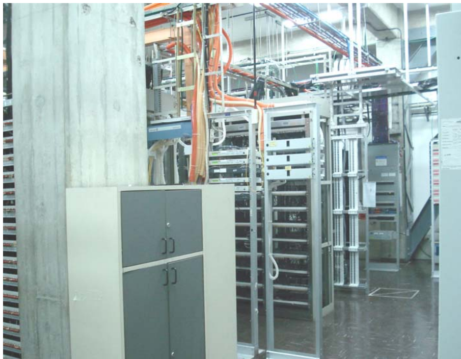
Figura. 3.18. Sala de Transmisión. Fuente CANTV.
