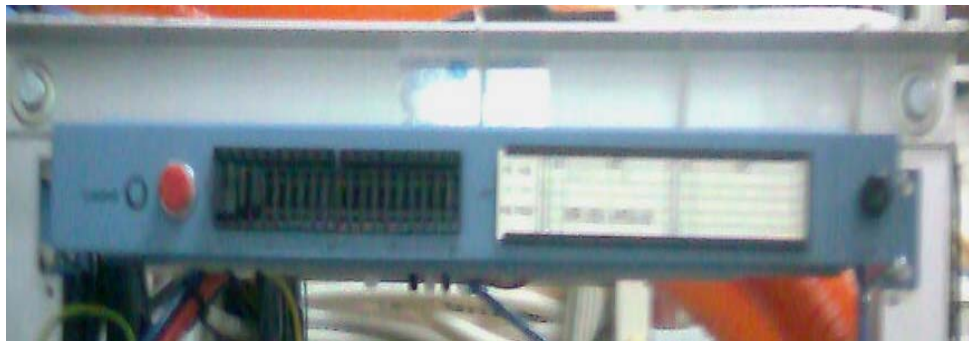
Figura. 4.13. Panel de fusible. Fuente CANTV.
