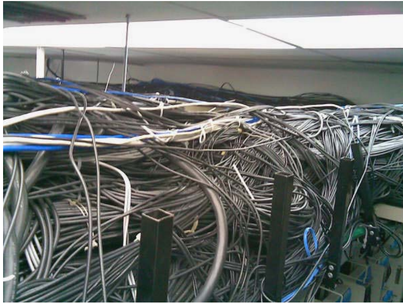
Figura. 3.6. Disposición actual del sistema cableado de la Sala de Conmutación. Fuente CANTV.
