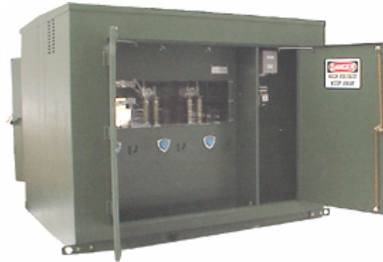
Figura 4.12. Filtro de armónico de modo PAD- Mounted.
