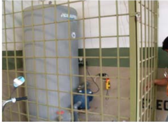
Figura 4.6 Hidroneumático del Centro Empresarial Teramo
