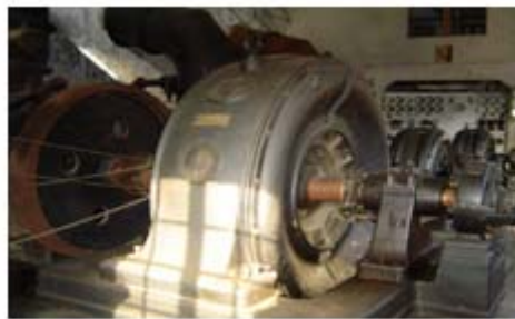
Figura 2.2. Generador de emergencia
